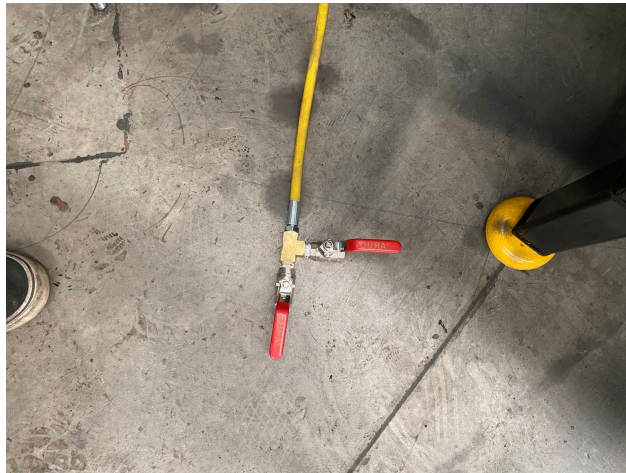
Figura 6.14: Válvulas de entrada y salida para el sistema neumático.
