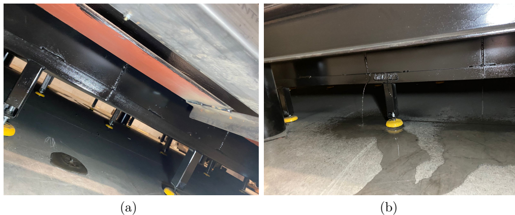
Figura 6.11: Filtraciones encontradas en el llenado parcial.
