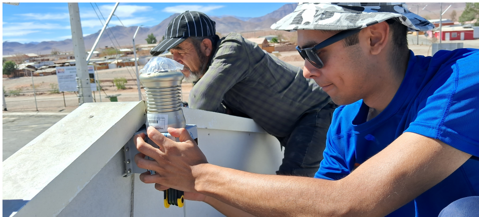
Figura 2.23: Instalación de cámara FRIPON perteneciente a la estación en Inca de Oro.
