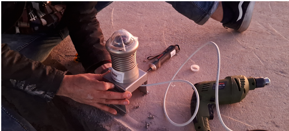
Figura 2.18: Instalación de una cámara FRIPON en uno de los techos del colegio Chuquicamata.
