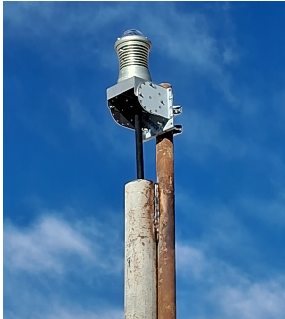
Figura 2.21: Cámara de la estación Laguna Santa Rosa.
