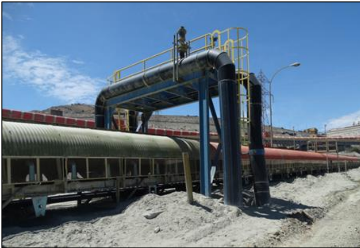
Figura 38: Interferencia - Ducto HDPE D=500 mm agua mina
