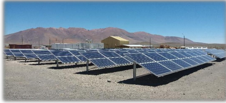
Figura 2.11: Planta híbrida de Cerro Pabellón.
