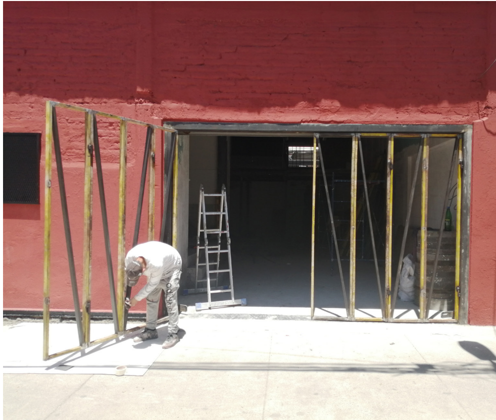
Registro fotográfico, proceso constructivo de reja en panadería en Persa Víctor Manuel Fuente: Elaboración propia
