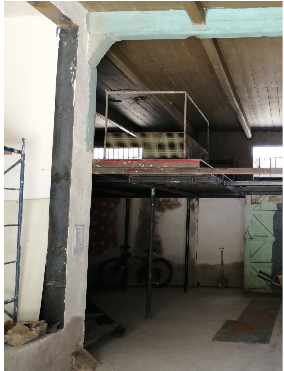
Primer estado de avance, construcción panadería (se rehace altillo usando los materiales preexistentes)
