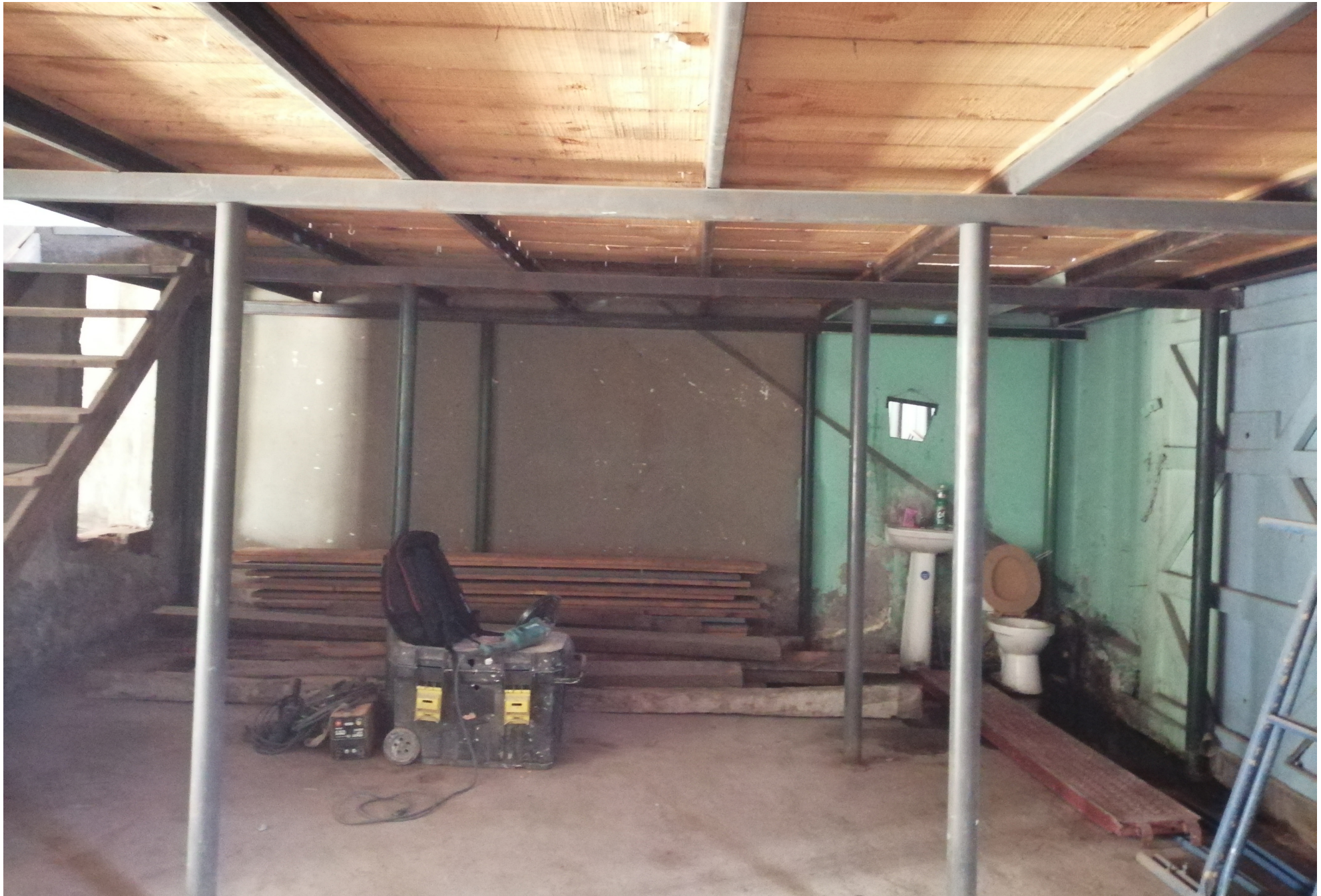
Registro Fotográfico de estado segundo piso de local donde se construiría panadería en Persa Víctor Manuel Fuente: Elaboración propia
