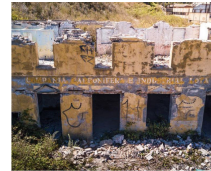
Lampareria, Sector Termoeléctrica. Fuente: AéreoLota
