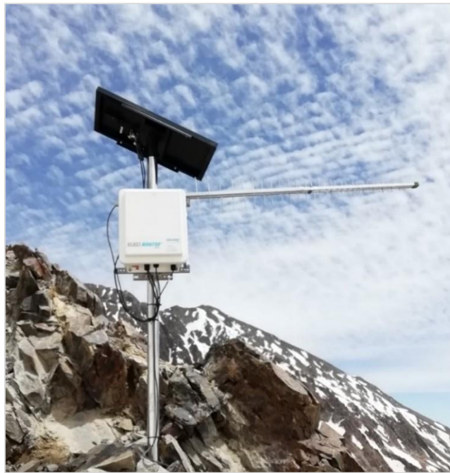
Figura 1. Estación de monitoreo inalámbrico, También llamada BM (BlastMonitor).
