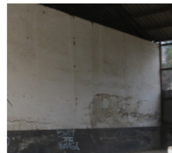
Erosión y suciedad
