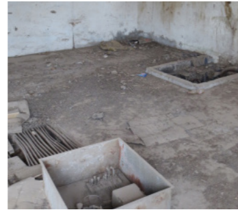
Suciedad y acumulación
