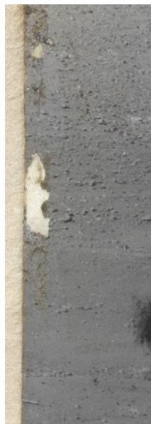
Figura 71. Faltante capa emulsión en fotografía 317 (CAQ - 2398 - N)
