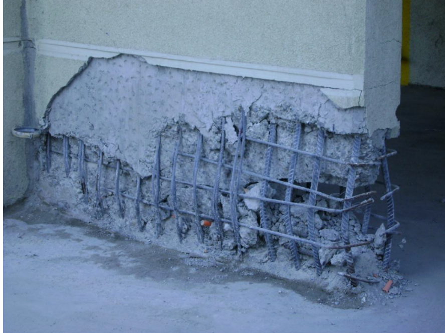
Figura 3.5: Aplastamiento del hormigón en muro de Eje 16. Leiva et al., 2010.
