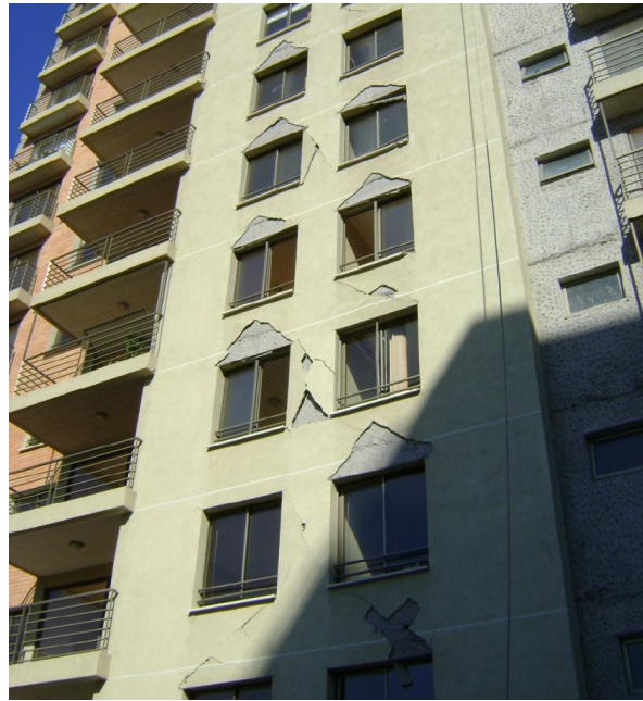
Figura 3.7: Daño por corte en el Eje 17. Leiva et al., 2010.
