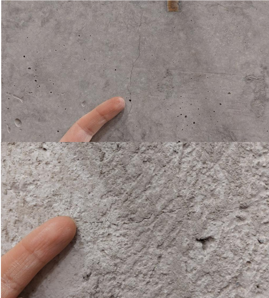
Figura 48. Agrietamiento de la losa AC.
