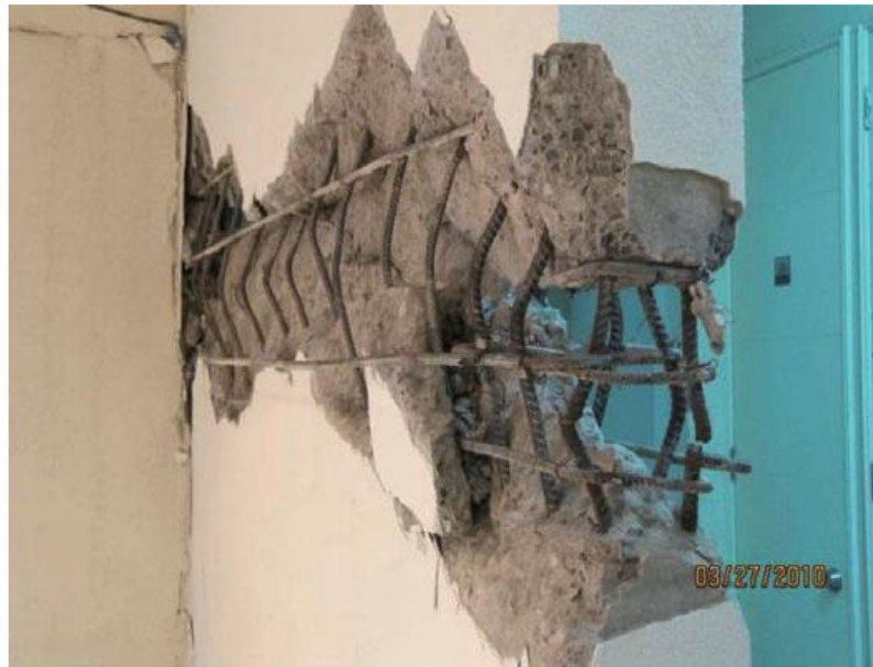
Figura 2. Pandeo de barras y confinamiento deficiente en borde de muro (Youssef, 2010).
