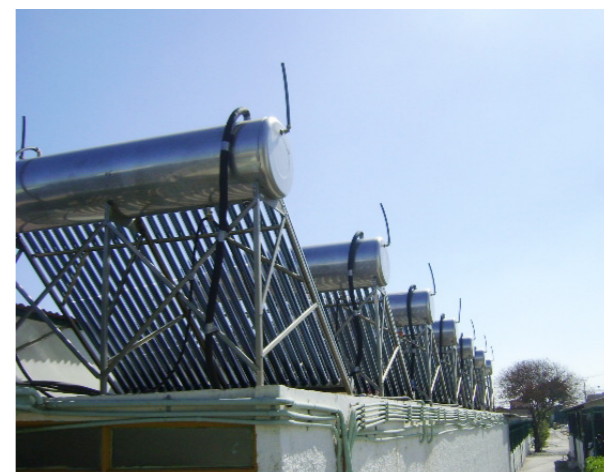
2.5 Instalación colectores de tubos al vacío en escuela de Carabineros - Antofagasta - Ejemplo de sistema no adaptado a la arquitectura
