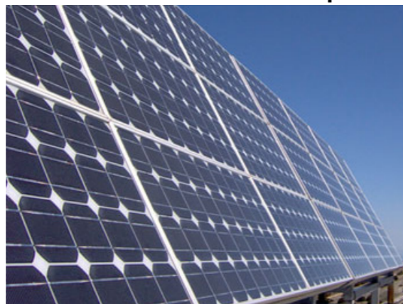
4.7 Fotografía Paneles Fotovoltaicos A través de un material semiconductor (silicio) captan la radiación solar y la transforman en electricidad.
