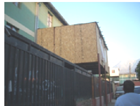
Ampliaciones irregulares en edificio “tipo bloque”
