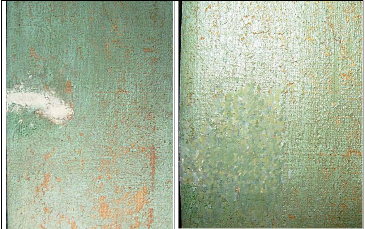
Detalle Borde izquierdo Antes y Después
