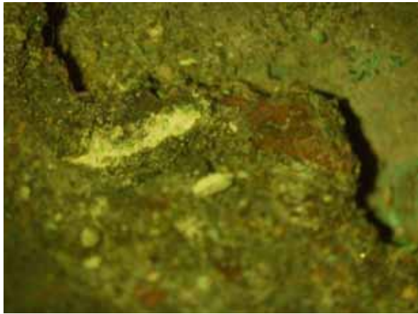
Microfotografía digital 20X corrosión activa, verde claro de aspecto pulverulento. (Neyra G.2009) Fig. N°11
