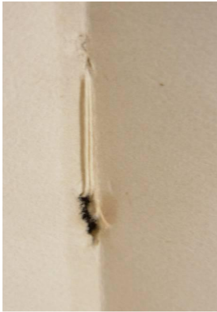
Rasgados y faltantes por costura antigua
