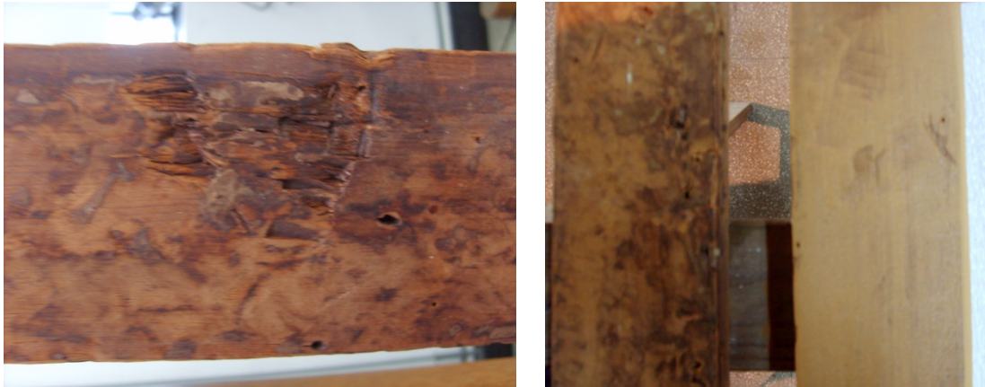
Fig.30 a la izquierda se observa un detalle del bastidor una vez retirado el papel A la derecha un detalle del bastidor antes y después de ser lijado
