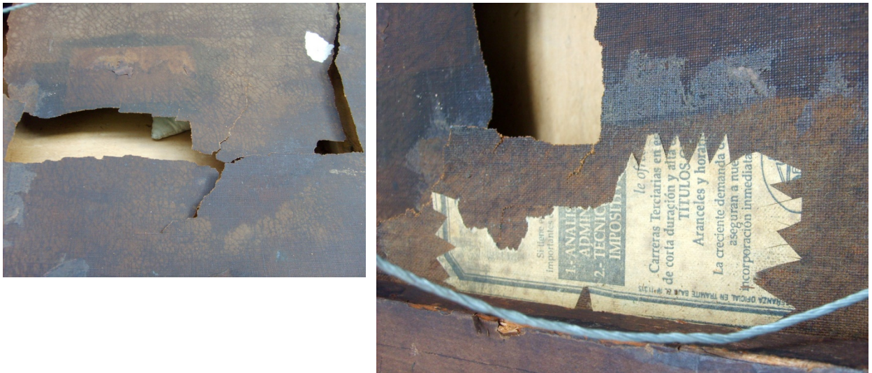
Fig. 18 Detalles de las Roturas de la pintura por el reverso
