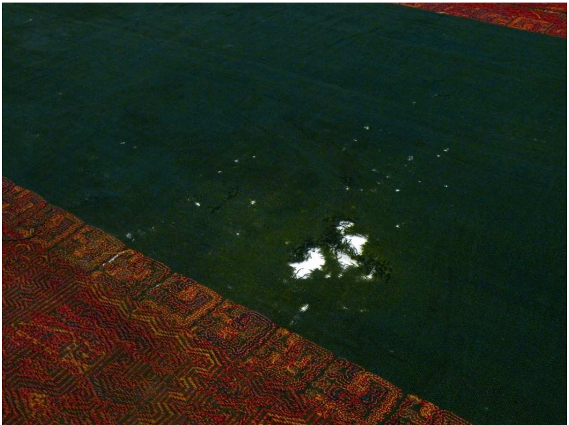
Imagen 57: Detalle cambio de color por oxidación.
