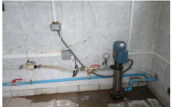
Fotografía G7.2.. Punto de muestreo sistema de cloración agua potable comuna de Santa Bárbara
