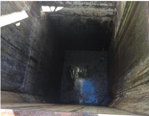
Fotografía G7.9.: Pozo ingreso aguas servidas crudas Planta Biobío, comuna de Concepción (afluente planta de tratamiento)
