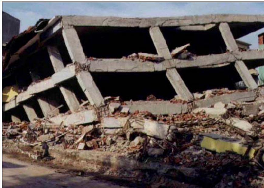
Foto n° 1: Falla de edificio en sismo de Kocaeli
