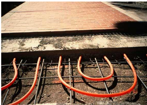
Fig. I-14 Tuberías con agua termal destinadas a derretir la nieve de una vereda en Klamath Falls, Oregon, E.E.U.U. (Esta foto, al igual que las otras de esta página, han sido obtenidas del sitio web de la Geothermal Education Office).
