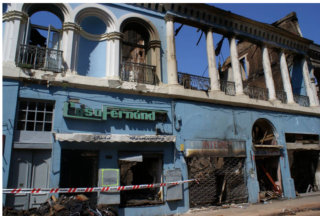
Figura 6.24 – Estado de la fachada de calle Serrano tras la explosión
