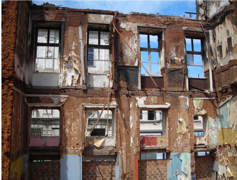
Figura 6.31 - Muros de albañilería sin refuerzo del segundo y tercer piso de la fachada por calle Cochrane
