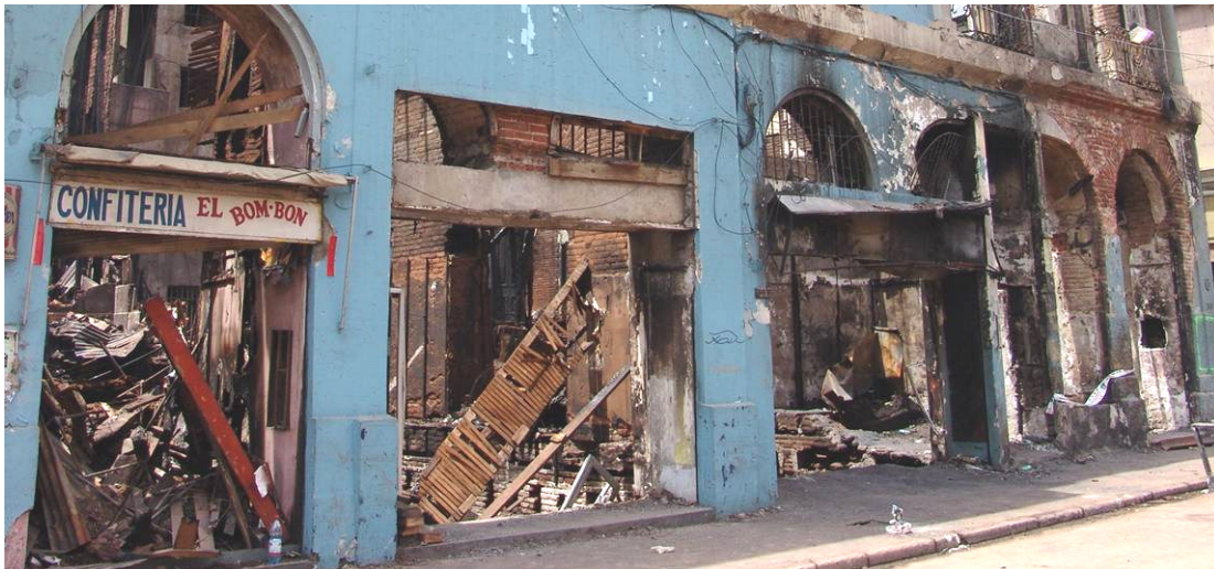
Figura 6.25 – Estado de la fachada de calle Serrano tras la explosión
