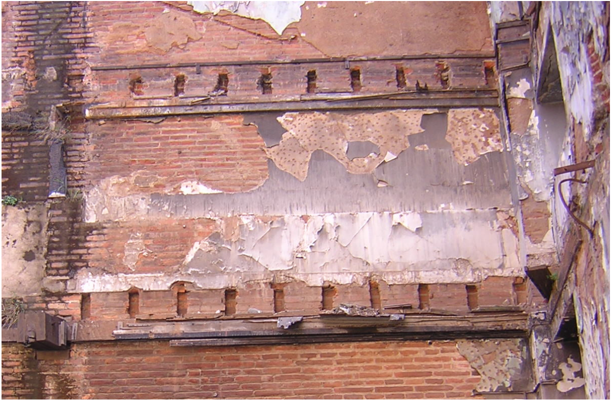
Figura 6.17 - Huecos en donde se apoyaban las vigas del piso y viga collar
