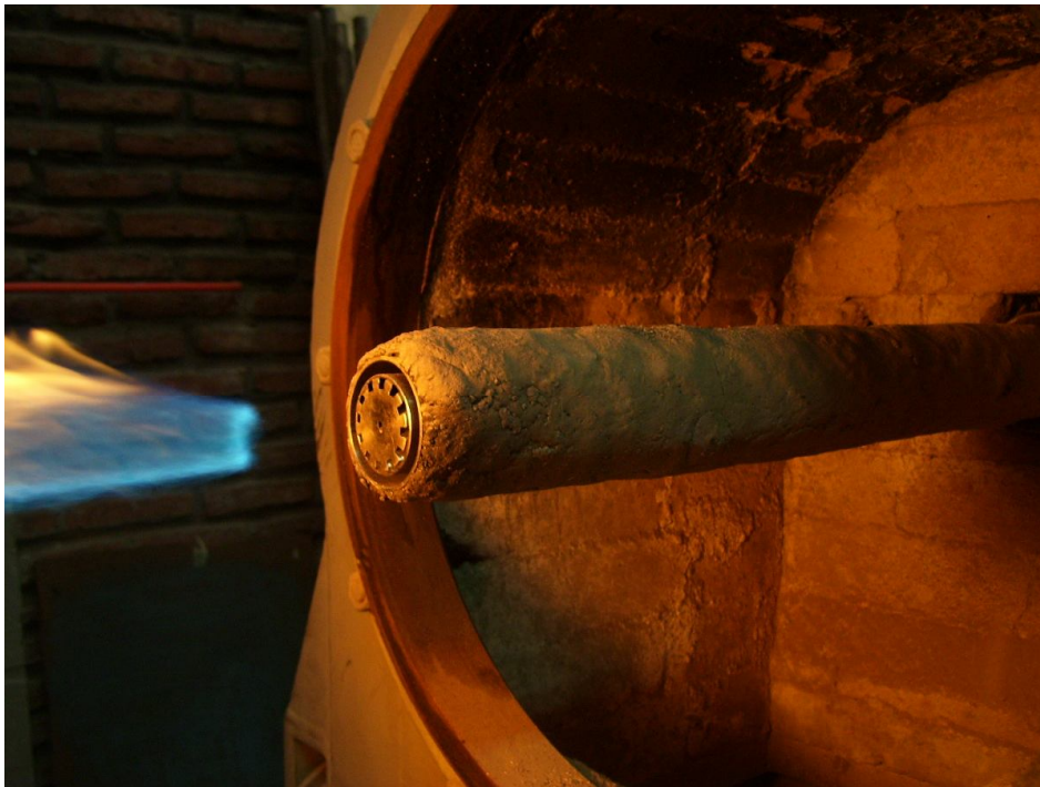
Figura 15: “Quemador de gas en operación”
