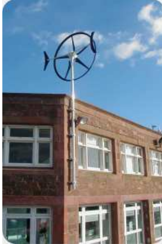
Ilustración 20. Pequeño aerogenerador de 1.5 kW instalado en edificio residencial, Inglaterra
