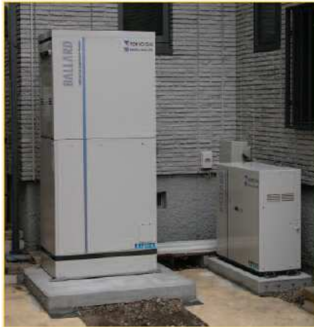
Ilustración 25. Celda de Combustible en Instalación domiciliar, Canadá
