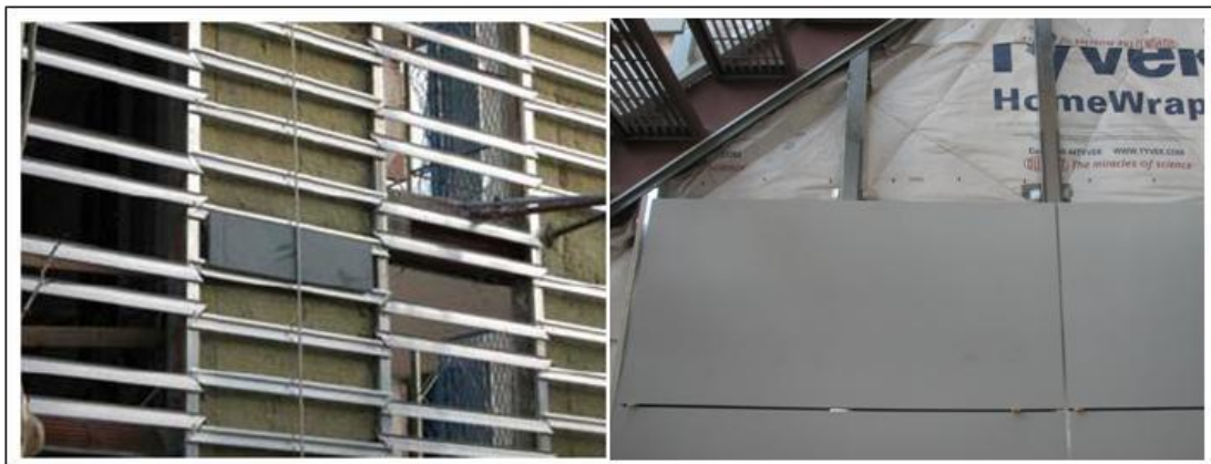
Fig. 3-r. FV en instalación.
