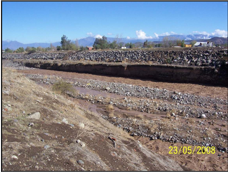
Foto N°7: Enrocados Socavados Aguas Arriba Puente San Luis
