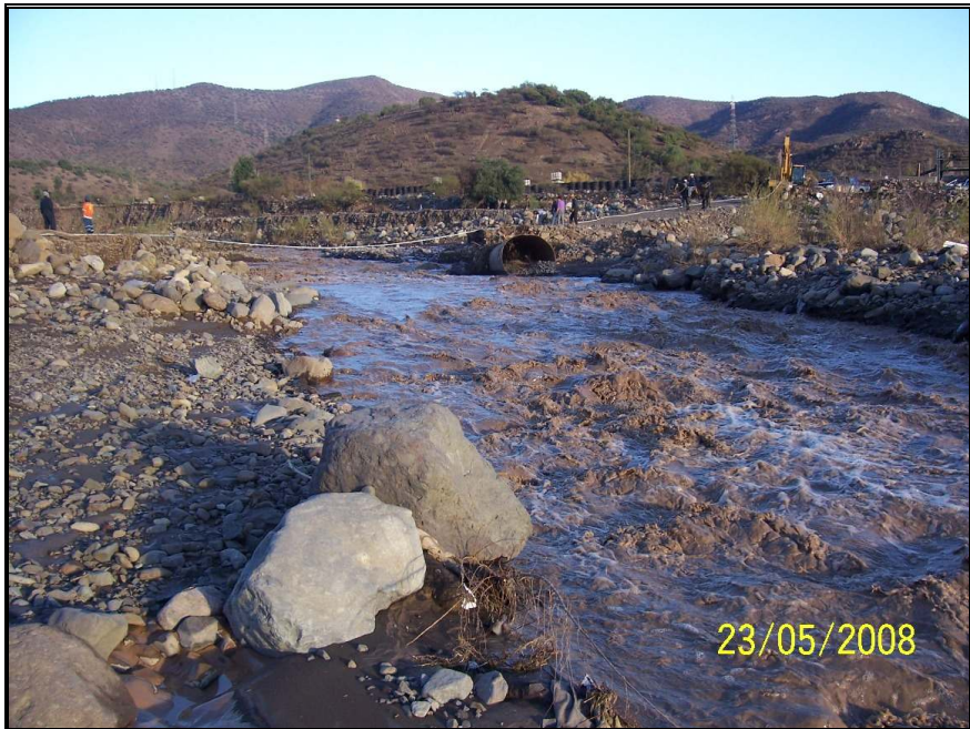
Foto N°16: Badén Peldehue Arrasado
