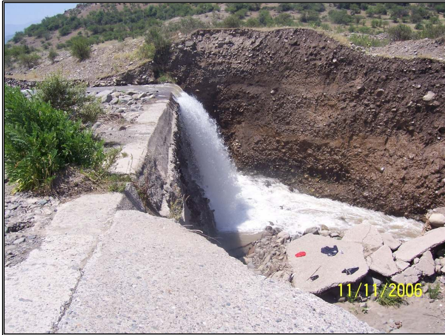
Foto N°11: Sifón El Molino, Como Vertedero Sin Protección al Pie
