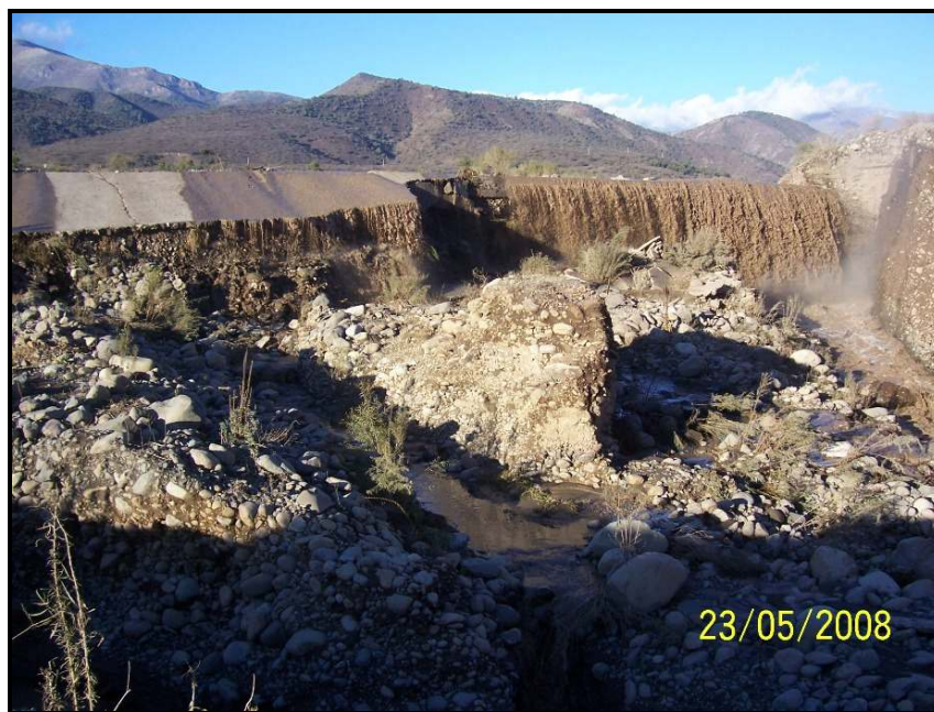
Figura N°19: Estado Sifón El Molino, Fotografía Crecida Mayo 2008
