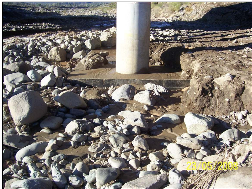
Foto N°12: Descalce Zapata Corrida - Columna, Puente Esmeralda
