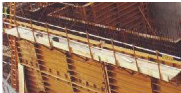
Figura 3.26: Plataforma de seguridad Plate Girder.
