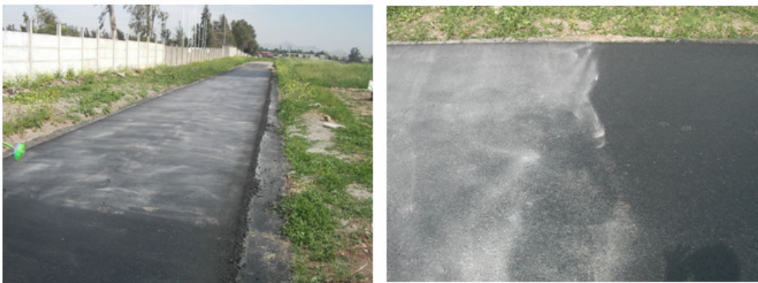
Figura 33: Contaminación de riego de liga, pista sobre hormigón
