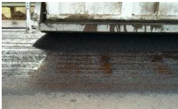
Figura 4: Aspecto de la superficie con aplicación excesiva de riego de liga
