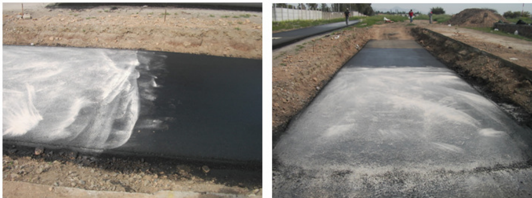
Figura 34: Contaminación de riego de liga, pista sobre base granular
