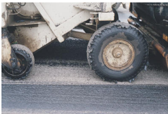
Figura 6: Riego de liga contaminado adherido a los vehículos de construcción:
