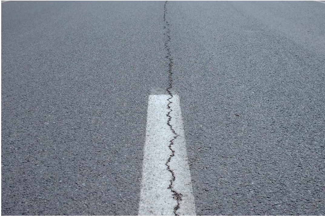
Figura 20: Grieta longitudinal en el eje de la calzada, San Felipe, V Región.
