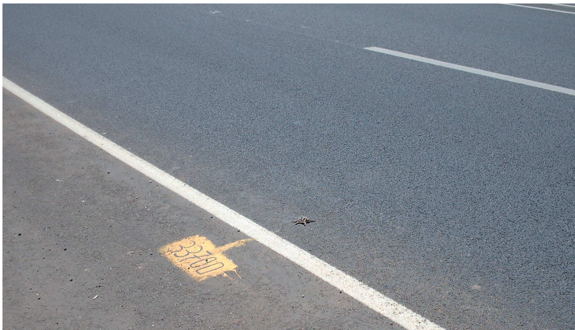
Figura 34: Regularidad de los tramos construidos con mezcla M-10 en la Ruta 160 (Dm. 33700), Sector Lota, VIII Región.
