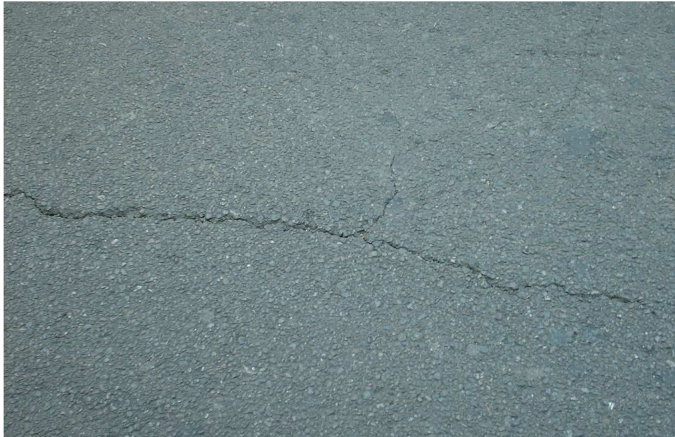
Figura 25: Grietas angostas en calzada poniente de la calle Gertrudis Echeñique, Región Metropolitana.
