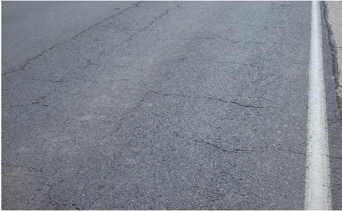
Figura 11: Grietas entrelazadas en el tramo F-10, San Felipe, V Región.
