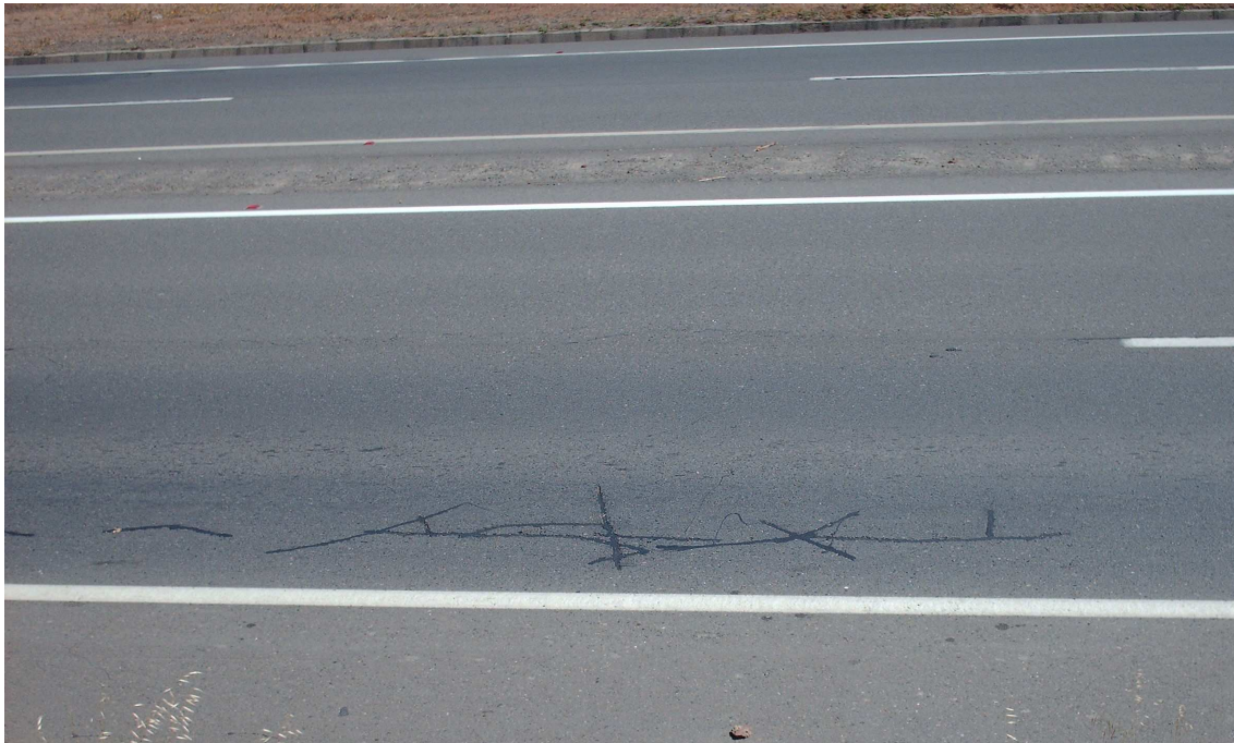
Figura 29: Zona con mezcla asfáltica tradicional y grietas correctamente selladas. Autopista del Itata, VIII Región.
