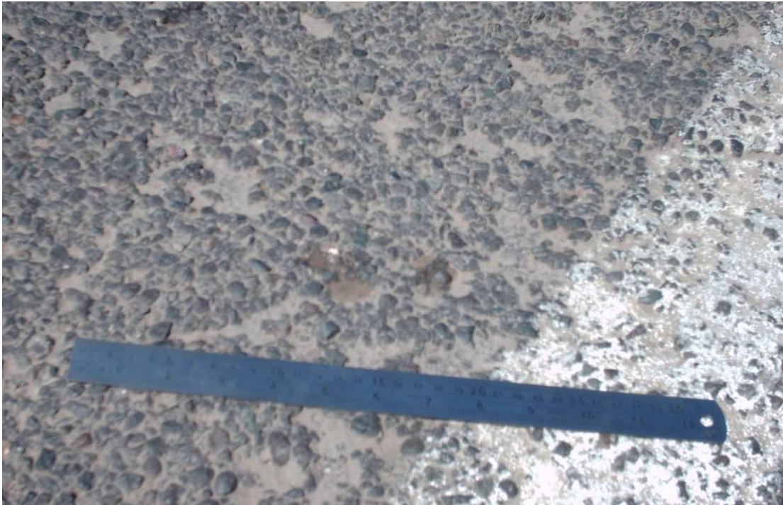
Figura 18: Desprendimiento de áridos en el tramo M-10, San Felipe, V Región.
