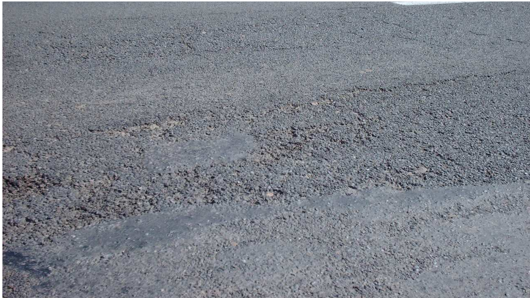
Figura 12: Desprendimiento de áridos en el tramo F-10, San Felipe, V Región.
