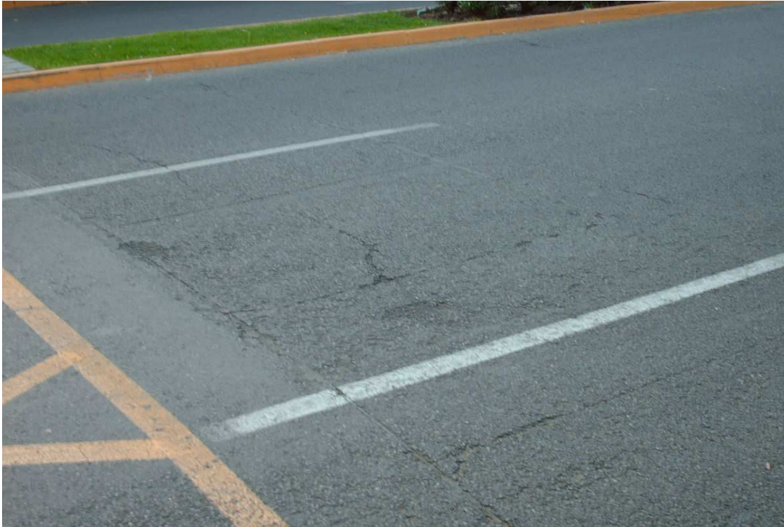
Figura 23: Falla en la intersección de las calles Gertrudis Echeñique y Renato Sánchez, Región Metropolitana.
