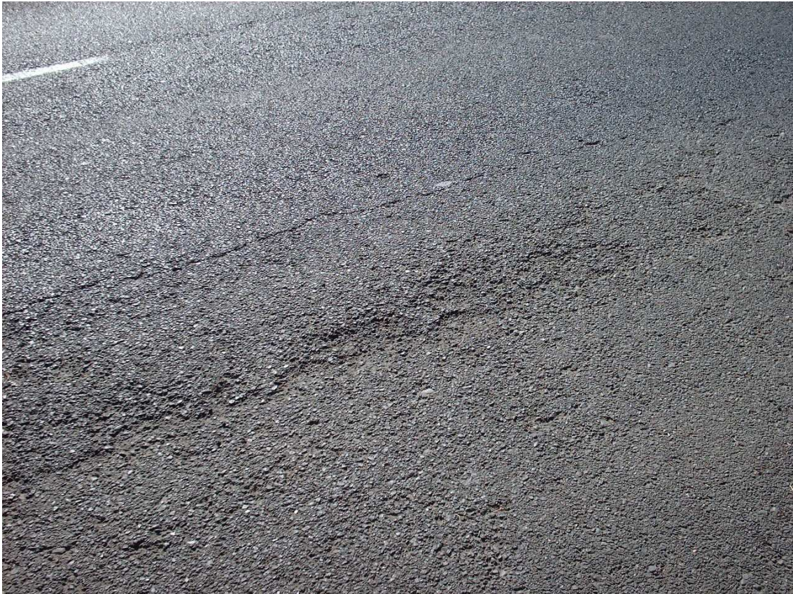
Figura 27: Pérdida de árido en la calzada oriente de la calle Gertrudis Echeñique, Región Metropolitana.
