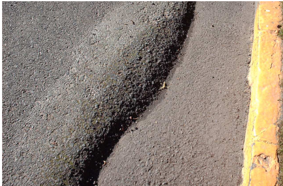
Figura 26: Falla en la zona de estacionamiento en la calle Gertrudis Echeñique, Región Metropolitana.
