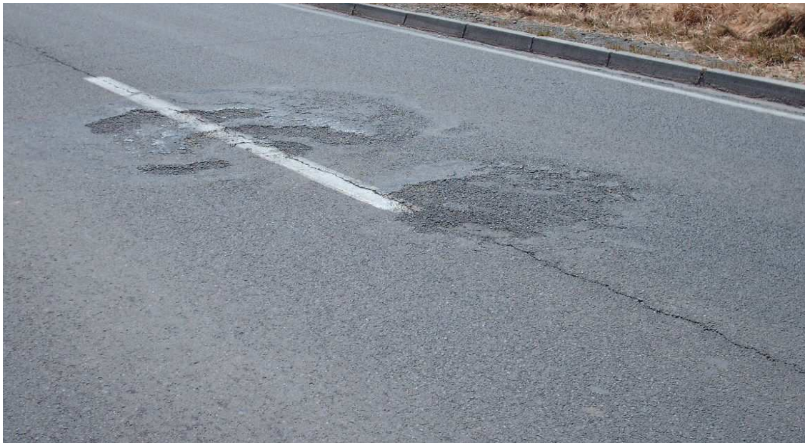
Figura 19: Daño Provocado por material quemado en el tramo M-10, San Felipe, V Región.
