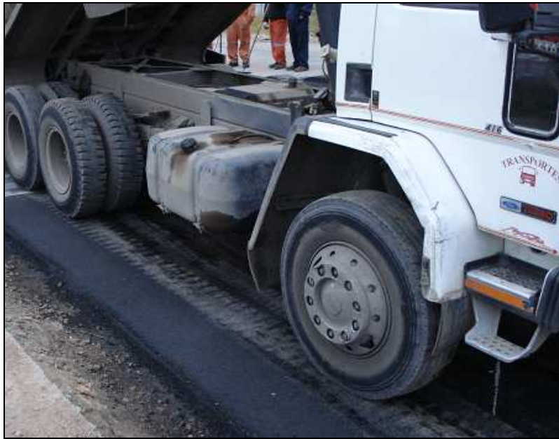
Figura 3.11: Contaminación causada por camión al cargar mezcla en máquina terminadora.
