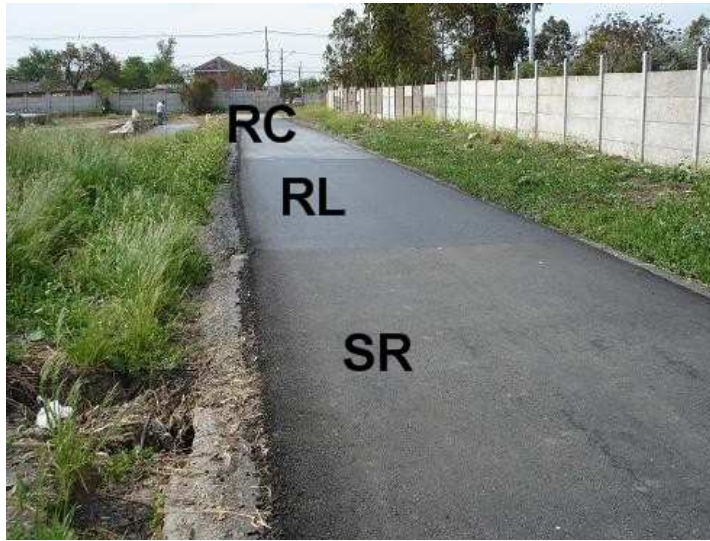
Figura 3.9: Superficie de primera capa asfáltica sobre HCR. Diferentes tratamientos en superficie: riego contaminado (RC), riego limpio (RL), sin riego (SR).
