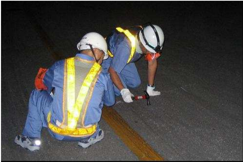
Figura 2.22: Inspección por método de auscultación con martillo en aeropuerto de Nagoya, Japón.
