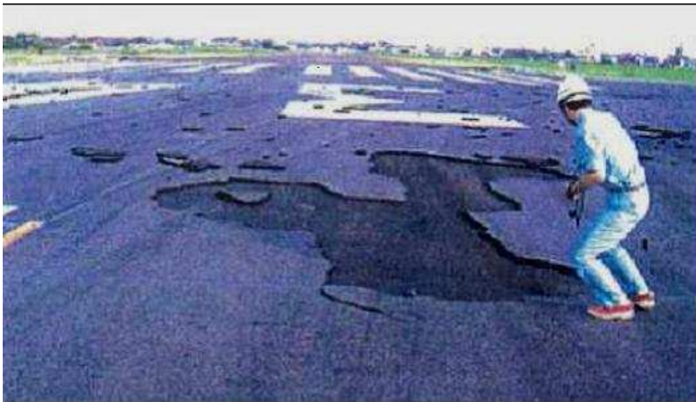
Figura 2.8: Falla de deslizamiento en Aeropuerto de Nagoya, Japón.
