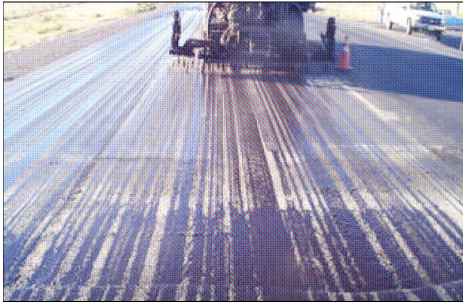
Figura 2.7: Aplicación no uniforme de riego de liga.
