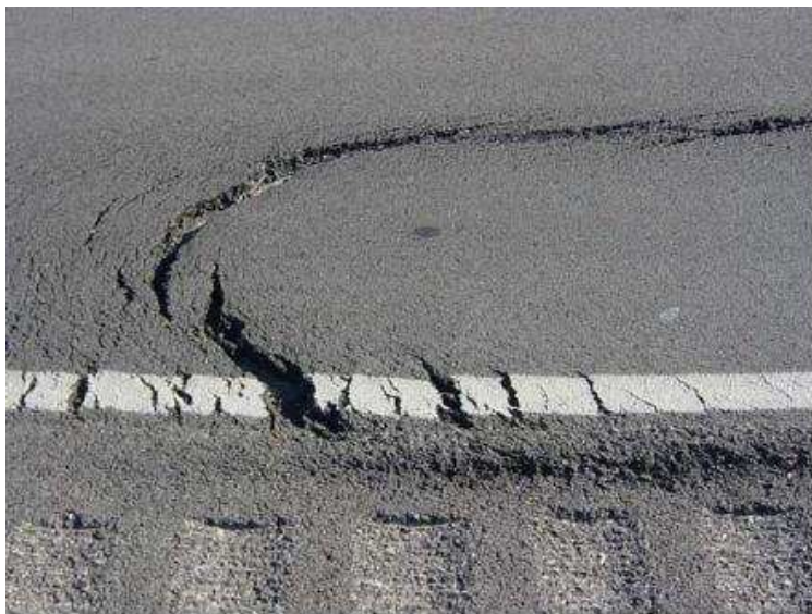
Figura 2.2: Falla de deslizamiento
