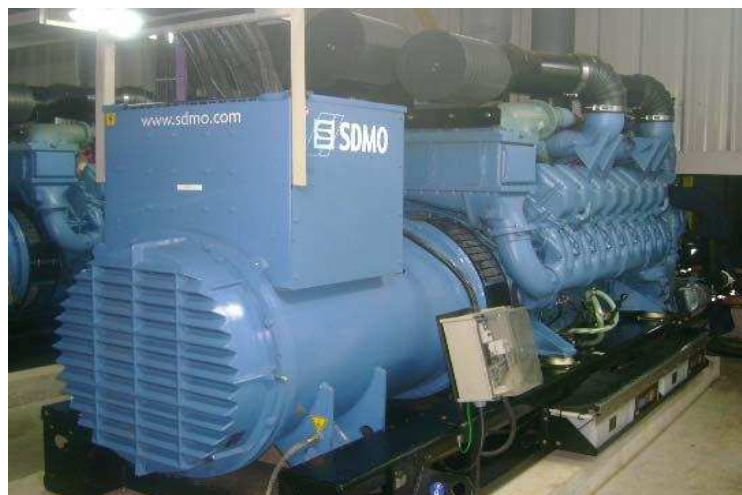
Figura 8, Grupo electrógeno, motor y generador [15].
