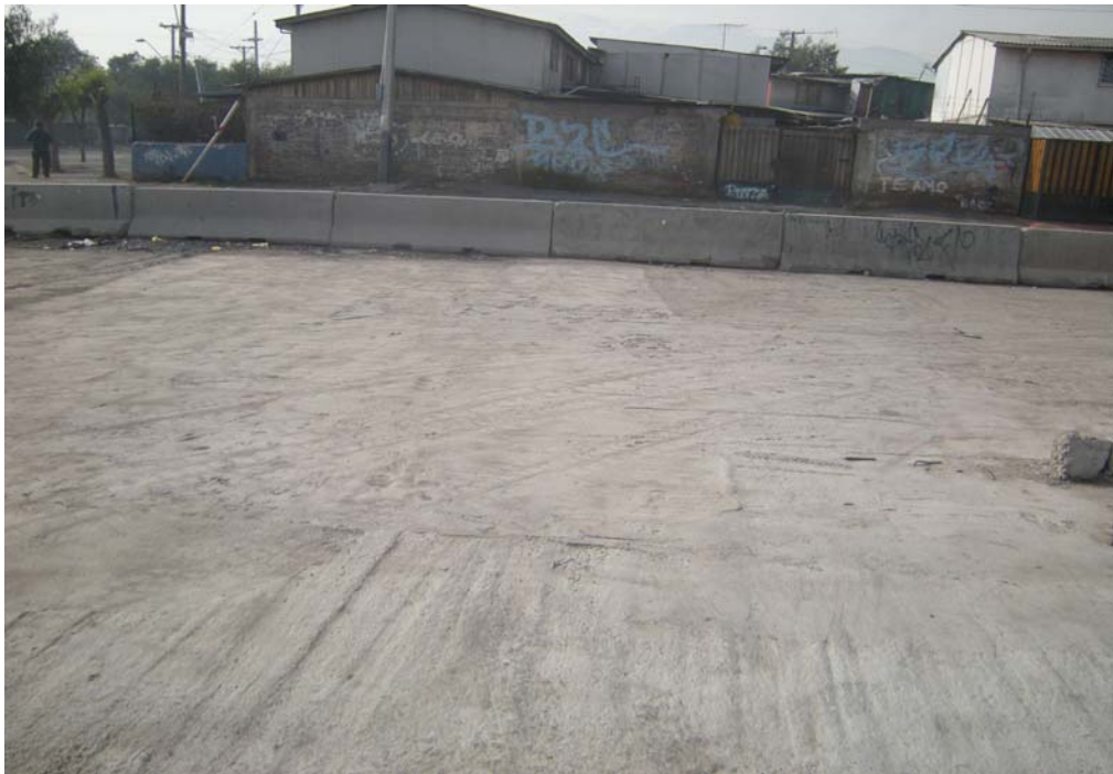
Fig. 6.1.3.10.2 Losas con Problemas de Textura Superficial. Problemas en colocación membrana. Se debe tener máxima precaución en la terminación de la losa.
