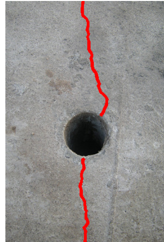
Fig. 7.1.1.1.1.4B. Línea Roja Describe con Mayor Detalle Trayectoria de Fisura.
