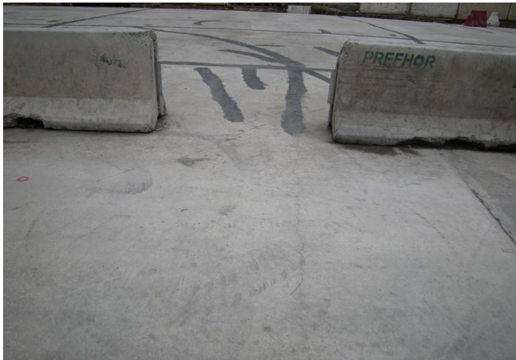
Fig. 6.1.3.7.18 Losas en Zona PK 1340, Entre Zona Control 1 y Calle Pedro Lira. Acercamiento fisura sin sellar.
