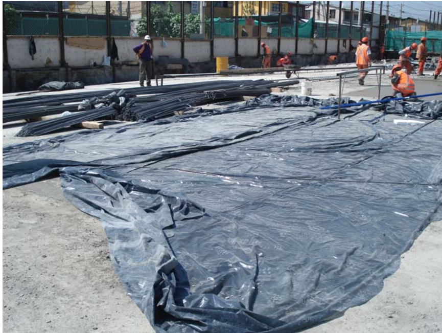
Fig. 2.3.20 Losa Terminada con Cubierta Protectora. Se aprecia que se utiliza una membrana plástica como cubierta protectora.
