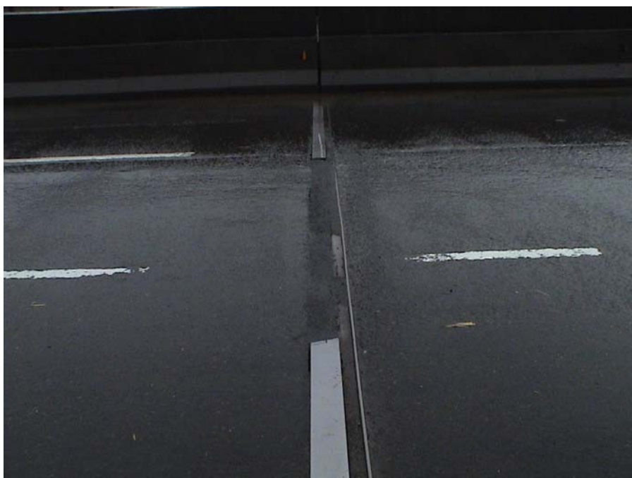
Fig. 1.3, Paso Superior Quilicura, Autopista Vespucio Norte, Junta en mal estado.
