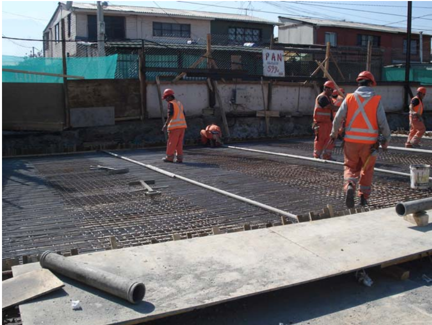
Fig. 2.3.6 Colocación Guías de Hormigonado y Separadores. Se pueden apreciar pequeños listones de madera que sobresalen, los que se utilizan para separar los paños a hormigonar de la losa.
