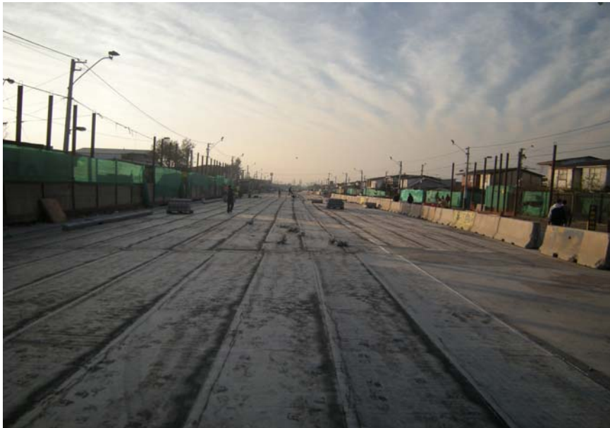
Fig. 2.3.23 Colocación de Membrana de Impermeabilización en Cubierta de Losa. Se puede apreciar que las membranas han sido colocadas traslapadas entre ellas.
