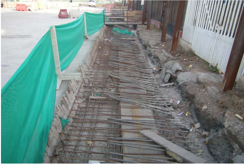
Fig. 6.1.3.11.1 Estado Losa Zona Control 1. Se ha retirado la pasarela peatonal dejando al descubierto la zona faltante para hormigonar. Se encuentra muy sucia con escombros.
