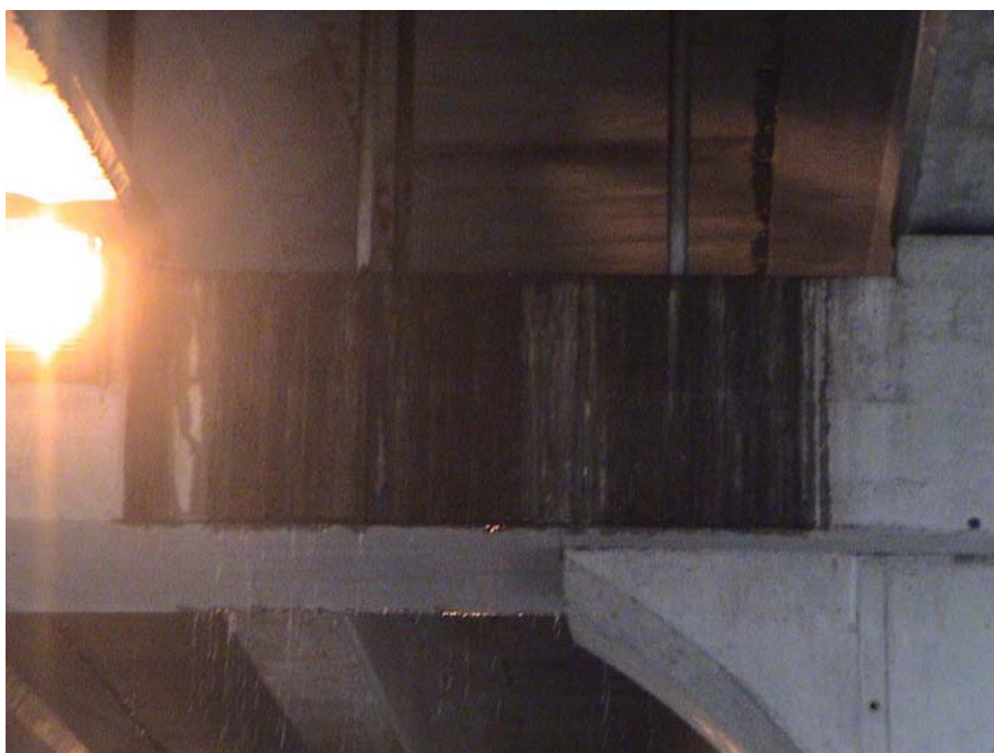
Fig. 1.2, Paso Superior El Salto, Autopista Vespucio Norte, Filtración en Junta en mal estado.
