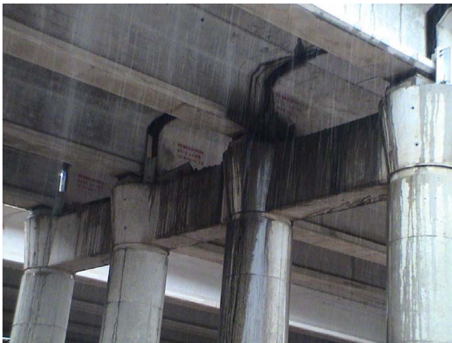
Fig. 1.4, Paso Superior Quilicura, Autopista Vespucio Norte, Filtración en Junta en mal estado.
