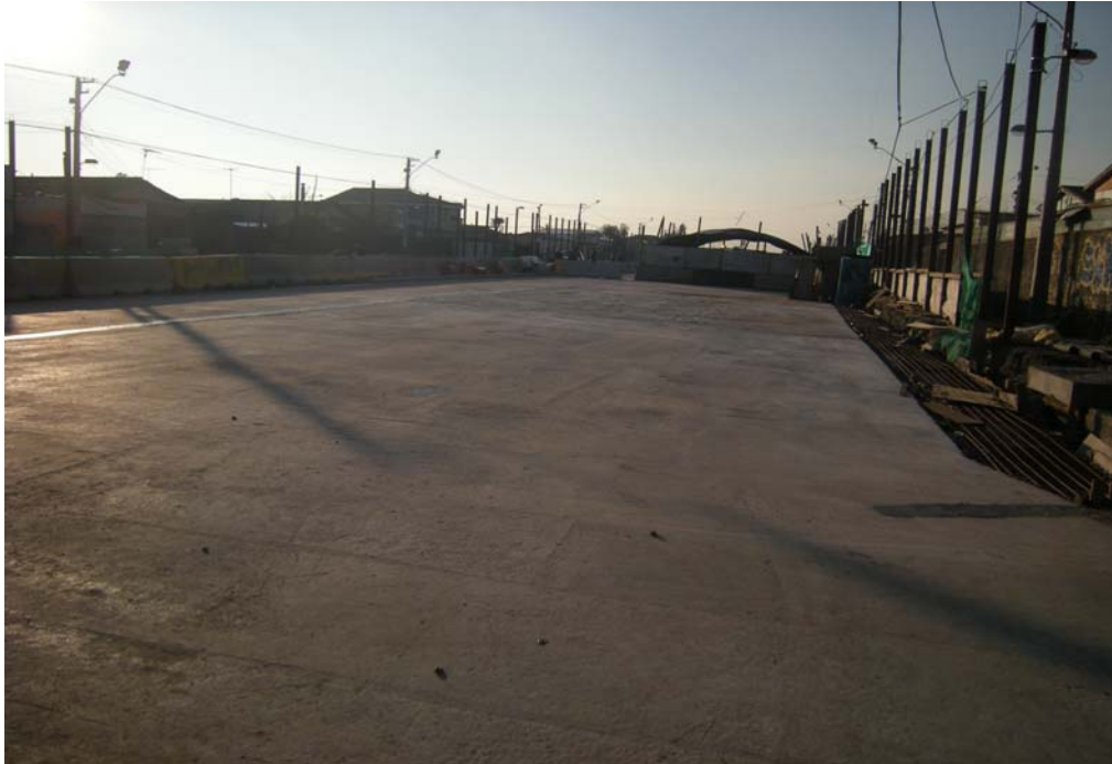
Fig. 6.1.3.13.9 Losa Oriente Fin Tramo 3. Aledaño Avenida San José de la Estrella. Sin fisuración. Losa extrema oriente sobre pilotes.
