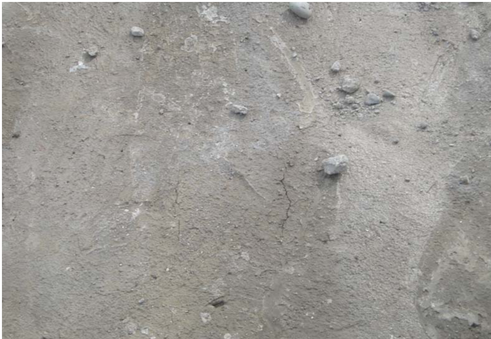
Fig. 6.1.3.14.6 Zona Control 1. Losa calzada oriente. Acercamiento hormigón regular calidad. Se aprecian fisuras.
