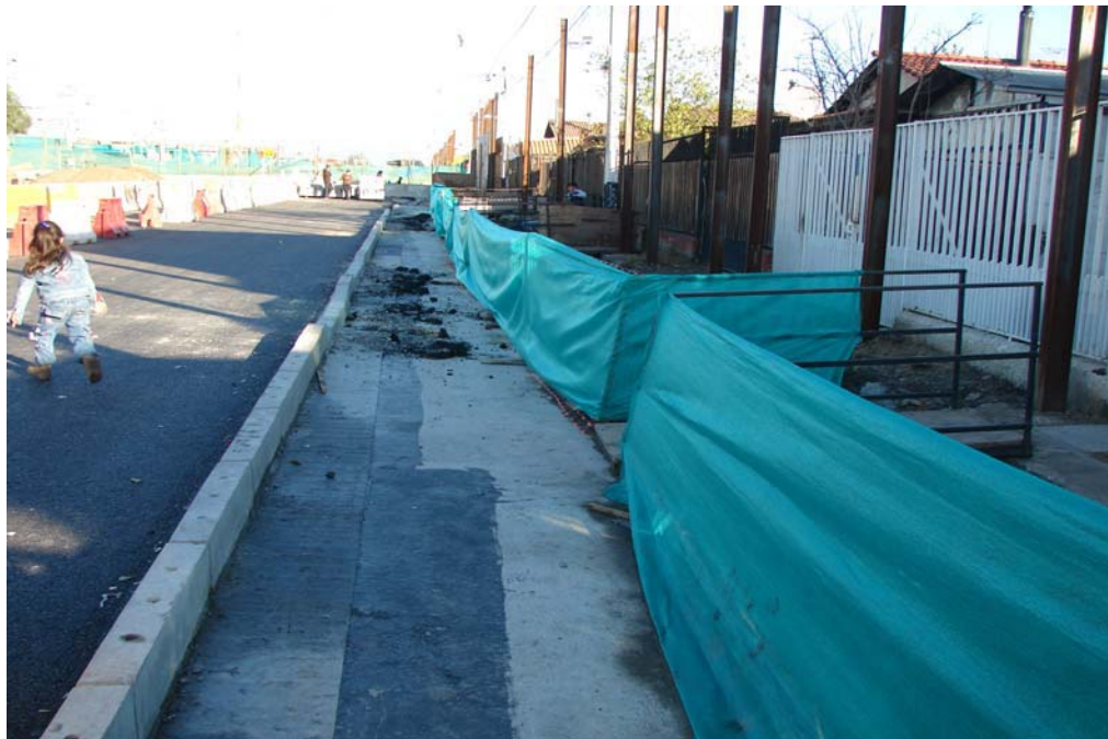
Fig. 6.1.3.12.2 Vista Zona Control 1. Sector de Losa sobre Pilotes Extremos Lado Poniente sin Hormigonar. Se Aprecia Borde de Membrana Impermeabilizante.
