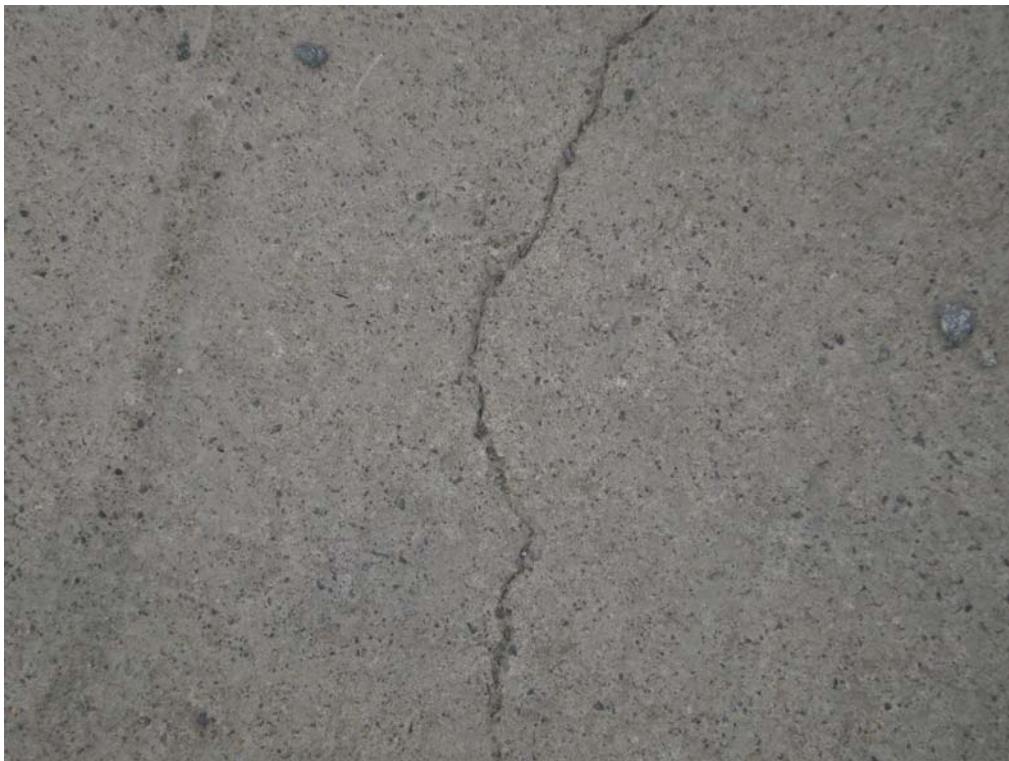
Fig. 6.1.3.7.4 Detalle Fisura Encontrada.
