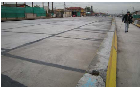
Fig. 7.1.1.1.3.1 Zona Sector Pedro Lira, Dañada con Fisuras, pero con Terminaciones Aceptables.
