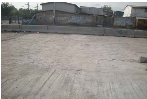
Fig. 7.1.1.1.3.2 Zona Sector General Arriagada, Dañada con Fisuras, pero con Terminaciones Claramente Deficientes, Se Prevé Problemas en la Puesta de la Membrana Sellante.
