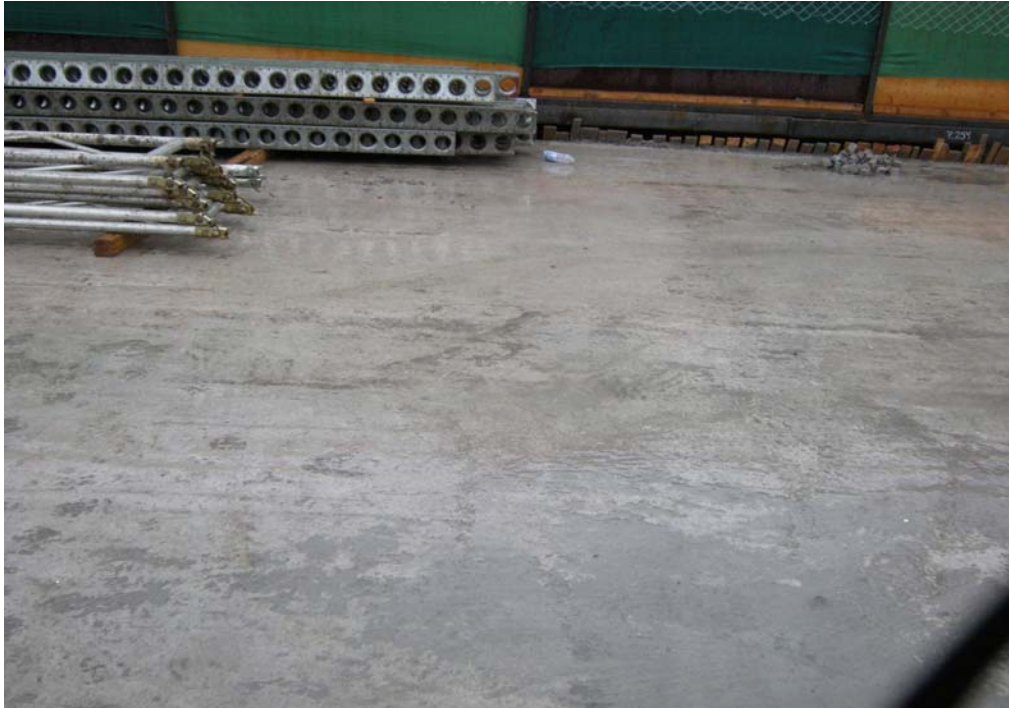
Fig. 6.1.3.5.1 Acercamiento Losa Central, Zona Control 1. Se aprecia limpia, bajo fuerte lluvia. No se aprecian fisuras.
