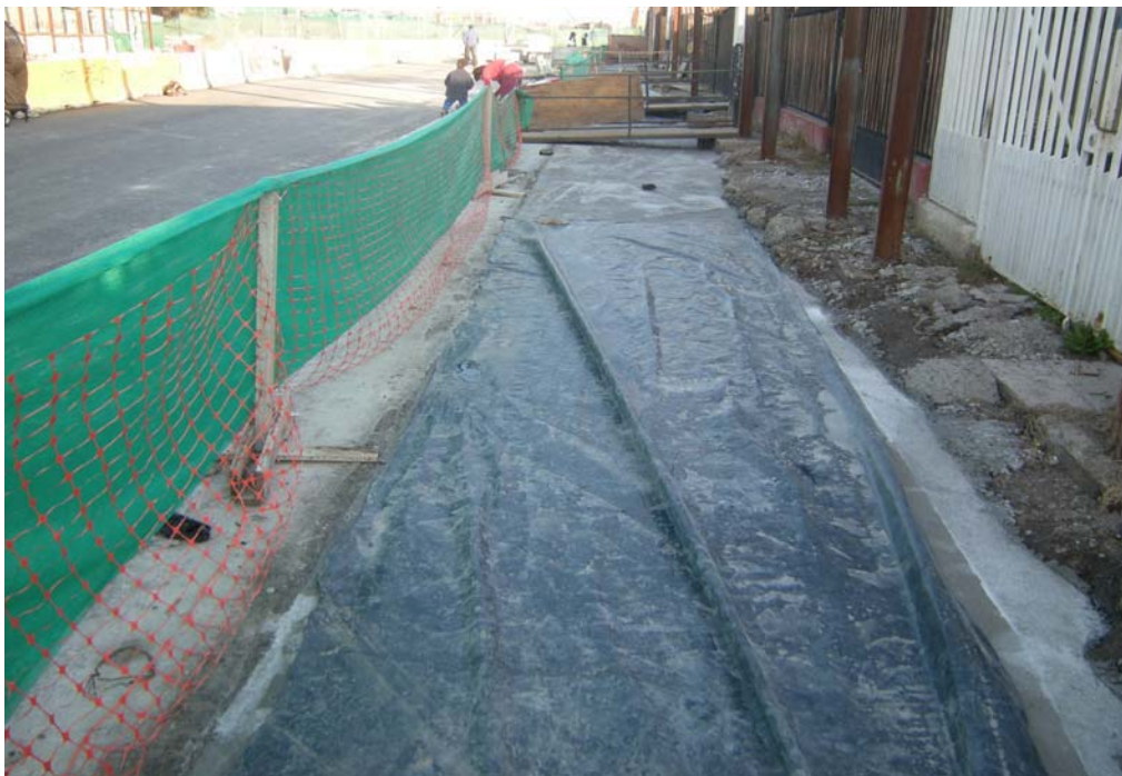
Fig. 6.1.3.13.2 Zona Control 1. Losa en zona extrema poniente sobre pilotes. No tiene fisuras.
