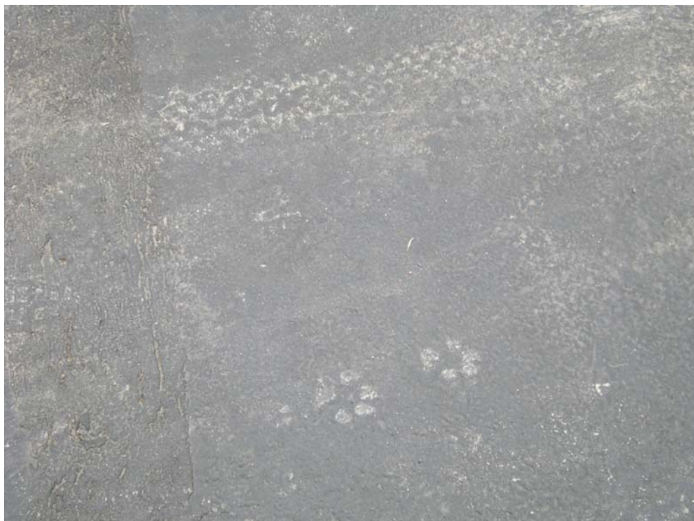
Fig. 6.1.3.7.2 Detalle Estado Losa de Control. Se aprecia marcas de tránsito.
