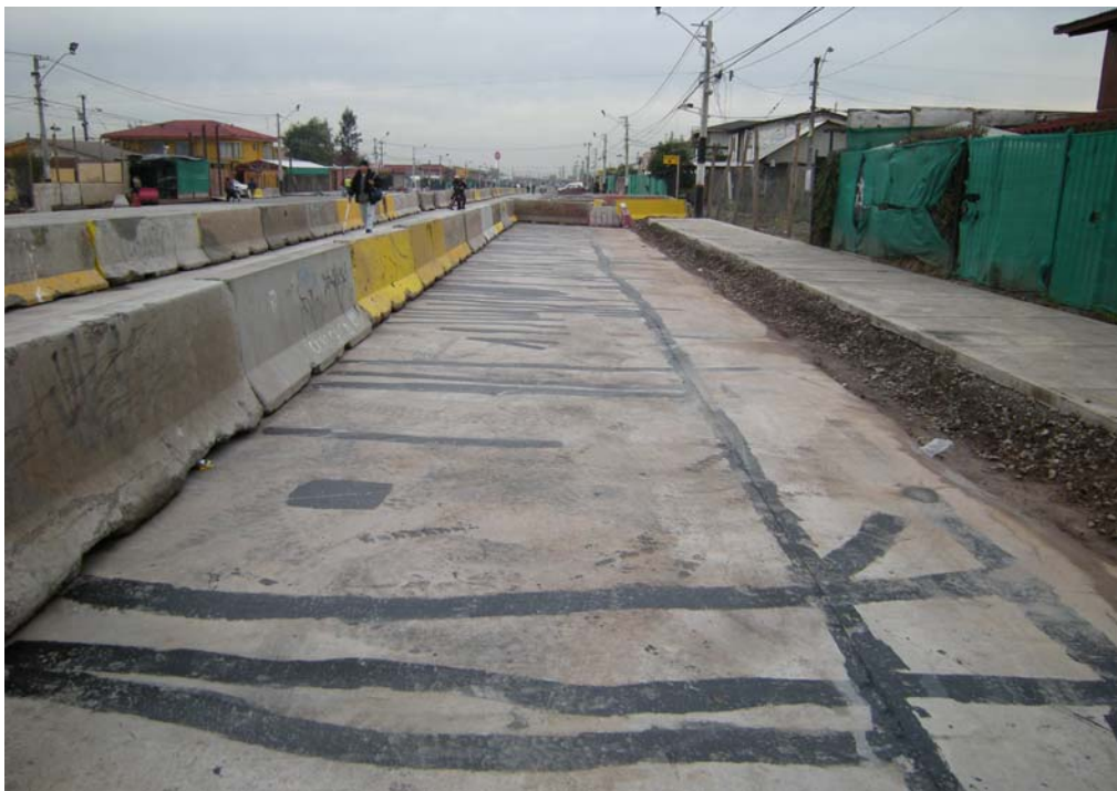
Fig. 6.1.3.7.14 Detalle Zona Cercada con Fisuras.
