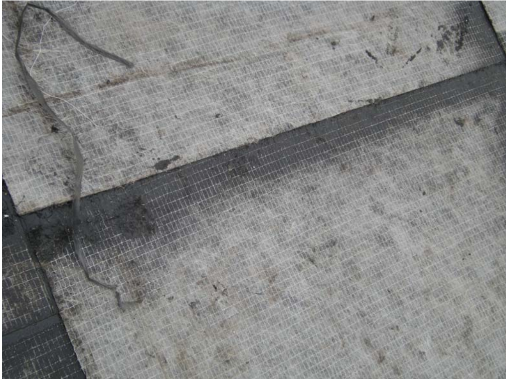
Fig. 6.1.3.7.3 Detalle Estado Membrana Impermeabilizante en Zonas Aledañas a Losa de Control.
