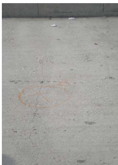
Fig. 7.1.1.1.2.2A Detalle Selección de Fisuras para Muestra, Sector General Arriagada, Calzada Poniente.
