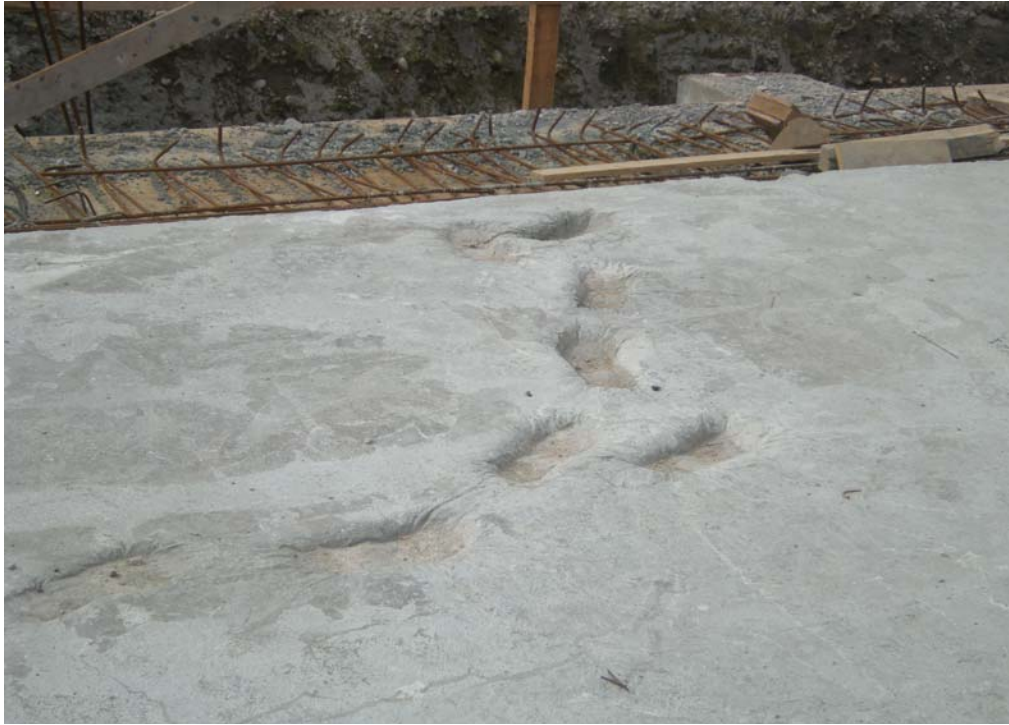
Fig. 6.1.3.14.11 Losa Calzada Poniente Inicio Tramo 4. Entre San José de la Estrella y Santo Tomas. Se aprecia una zona de losa con claro daño superficial.
