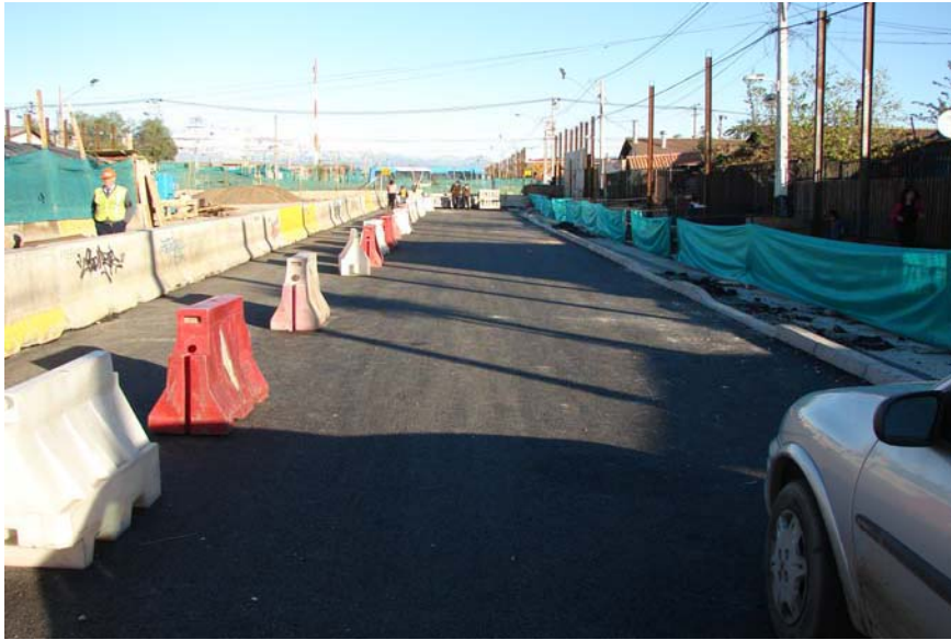
Fig. 2.3.24 Tramo de Losa con Pavimento. La etapa final corresponde a la colocación de la carpeta asfáltica de rodado.
