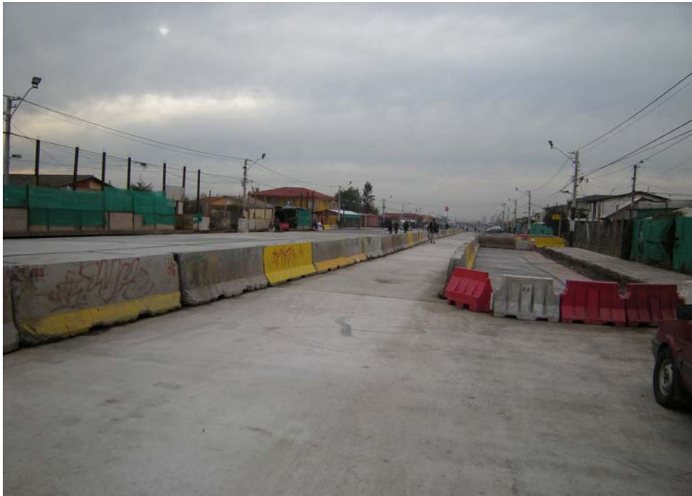
Fig. 6.1.3.7.13 Losas en Zona PK 1340, Entre Zona Control 1 y Calle Pedro Lira. Se aprecia zona cercada con fisuras ya selladas.
