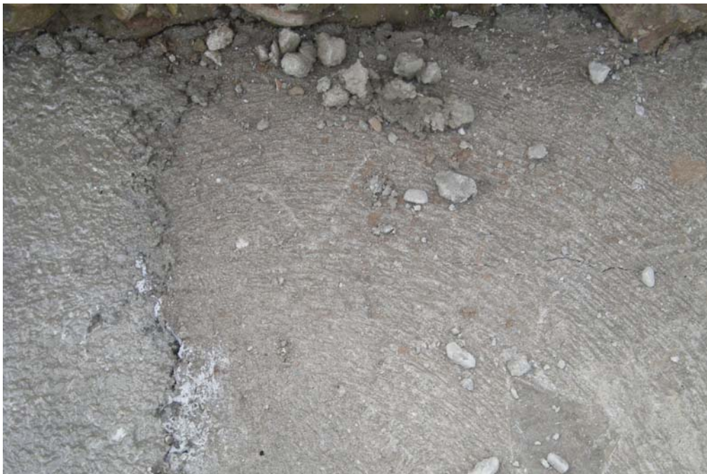
Fig. 6.1.3.14.8 Zona Control 1. Losa calzada oriente. Acercamiento hormigón regular calidad. Junta de construcción.
