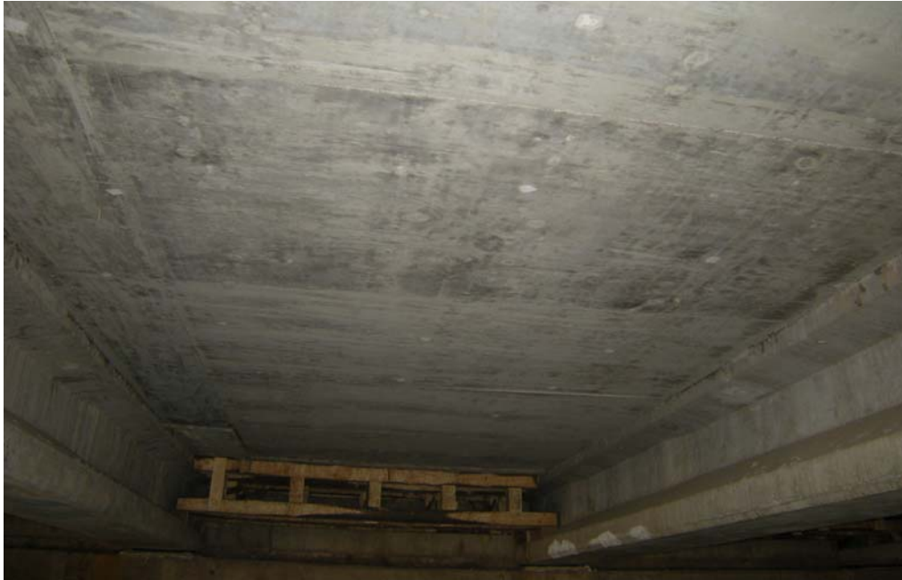
Fig. 6.1.3.14.13 Losa Calzada Poniente Inicio Tramo 4. Junto a Santo Tomas. Vistas inferiores de losas. No se observan fisuras.
