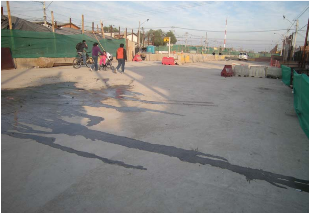
Fig. 6.1.3.11.3 Estado Losa Zona Control 1. No Presenta Novedades. No Presenta Membrana ni Pavimento. No Presenta Fisuras. Pendiente hormigonado zona extrema losa, lado poniente sobre pilotes.
