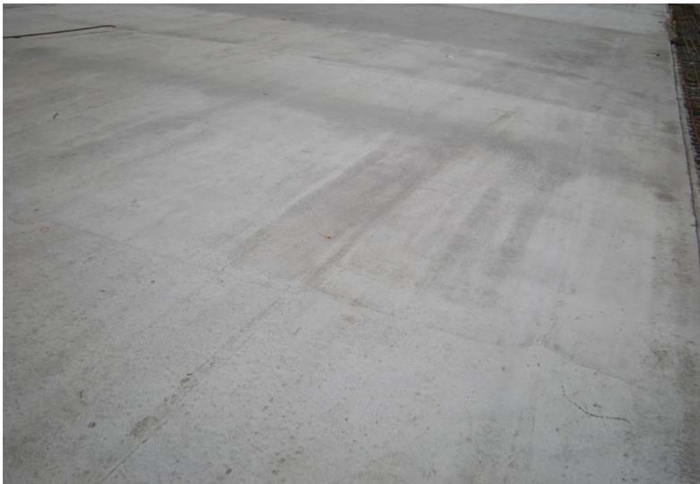
Fig. 6.1.3.14.10 Losa Calzada Poniente Inicio Tramo 4. Entre San José de la Estrella y Santo Tomas. Se aprecia una losa sana, Sin fisuras. Detalle.
