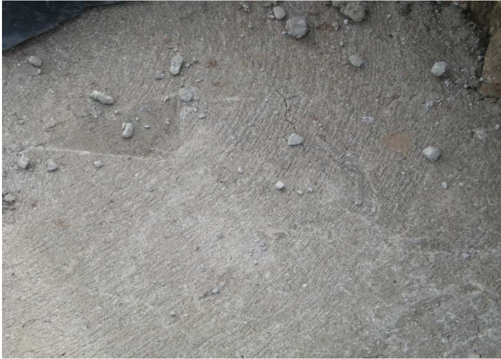
Fig. 6.1.3.14.7 Zona Control 1. Losa calzada oriente. Acercamiento hormigón regular calidad. Se aprecian fisuras.
