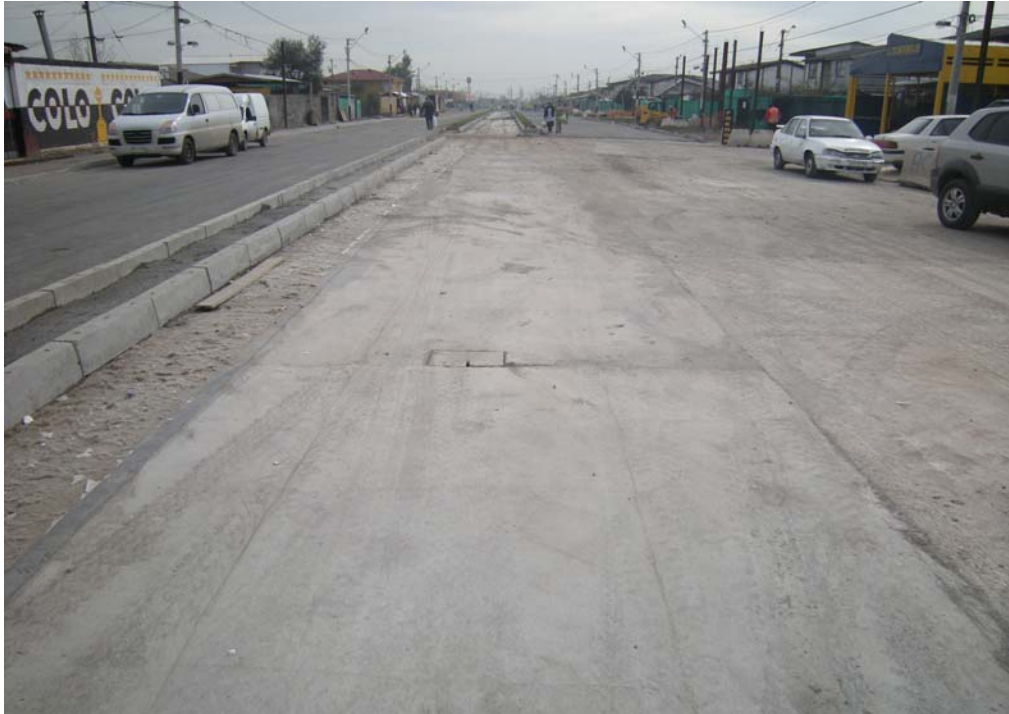
Fig. 6.1.3.14.3 Losa Calzada Oriente Zona Control 1. Sin pavimento con losa a la vista. Sin fisura.
