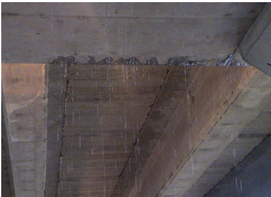
Fig. 1.1, Enlace Independencia, Autopista Vespucio Norte, Filtración Agua Lluvia por Junta en mal estado.
