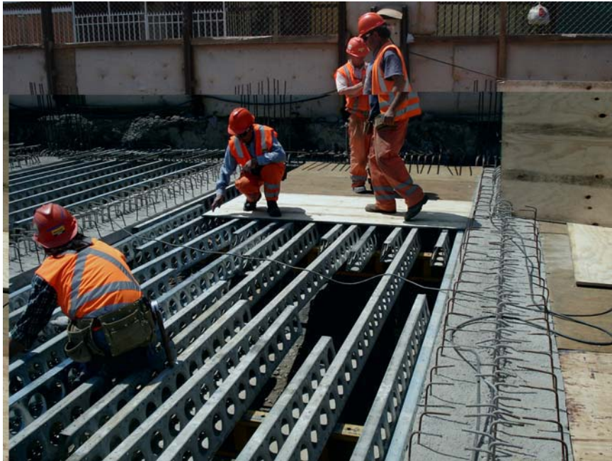
Fig. 2.3.2 Colocación Moldaje Inferior Losa entre Vigas Prefabricadas. Se aprecia en la fotografía los apoyos del moldaje de losa.
