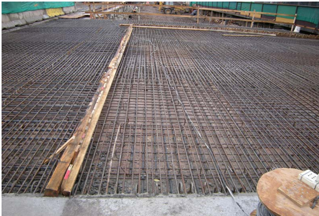
Fig. 6.1.3.2.2 Armaduras en Zona de Losa Poniente, que se Hormigona Primero. Se controlaron espesores de losa, recubrimientos y ferralla. Ver punto 6.1.2.
