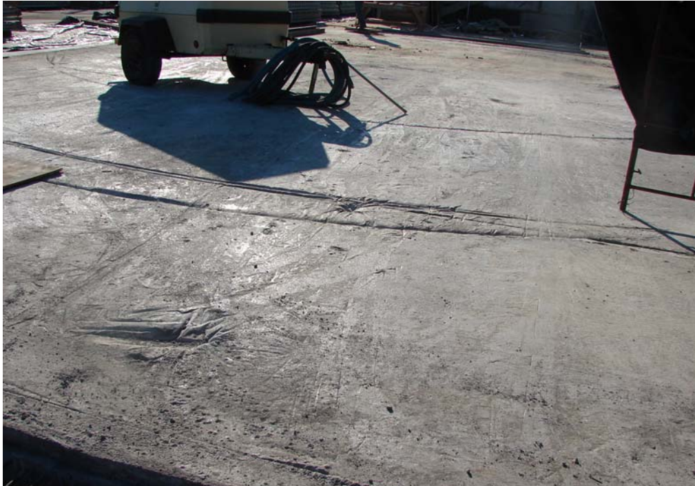
Fig. 6.1.3.6.5 Losa Oriente Pilotes 264 a 267. Se aprecia daño superficial en la losa.
