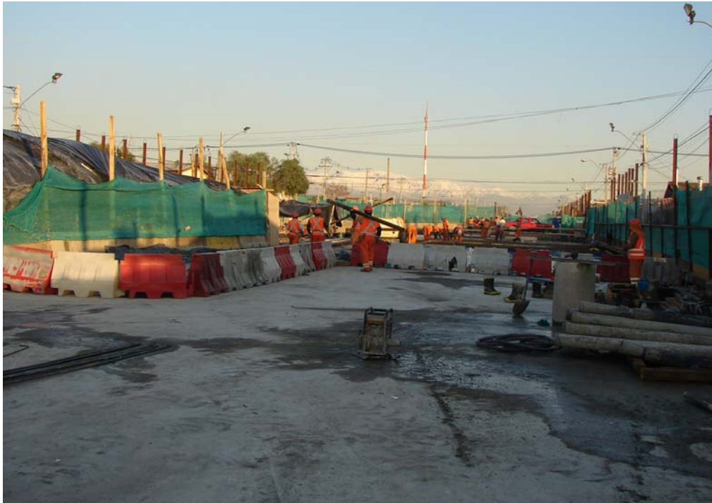
Fig. 6.1.3.4.1 Losa Central, Zona Control 1. Sin protección y con movimiento, muy sucia. No se aprecian fisuras. Por las características que rodean a este proyecto, será habitual que las zonas ya hormigonadas sean usadas como zonas de almacenaje y de tránsito para la faena.
