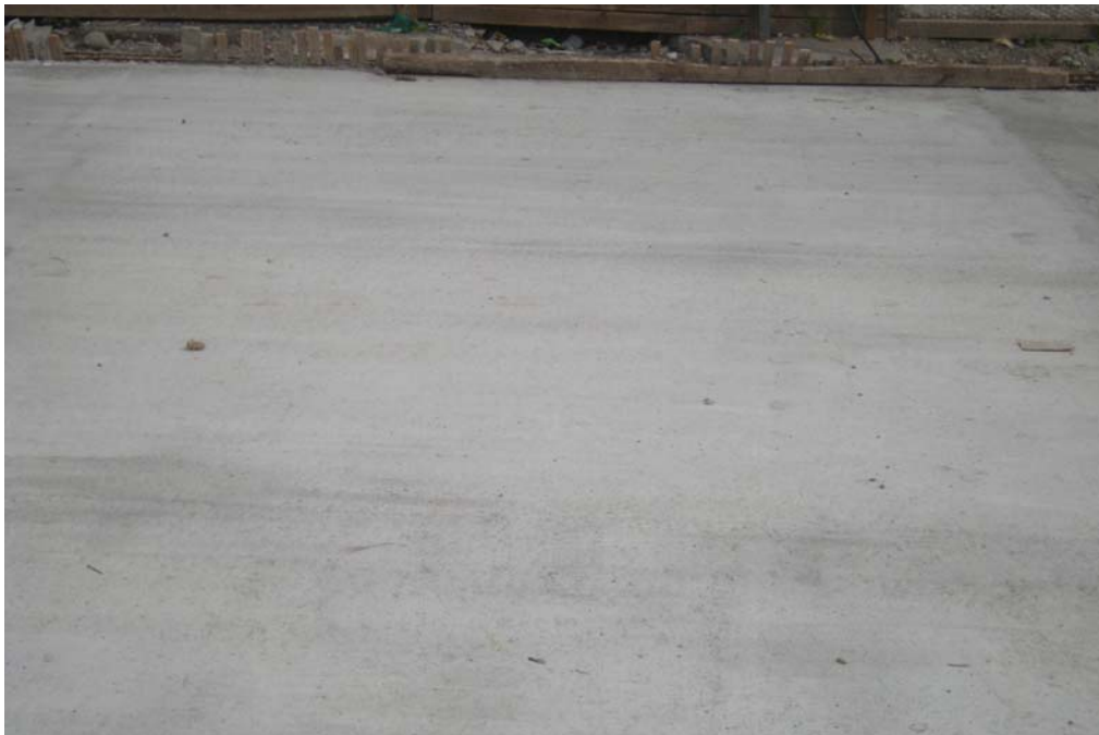
Fig. 6.1.3.14.12 Losa Calzada Poniente Inicio Tramo 4. Entre San José de la Estrella y Santo Tomas. Se aprecia una zona de losa sin fisuras.
