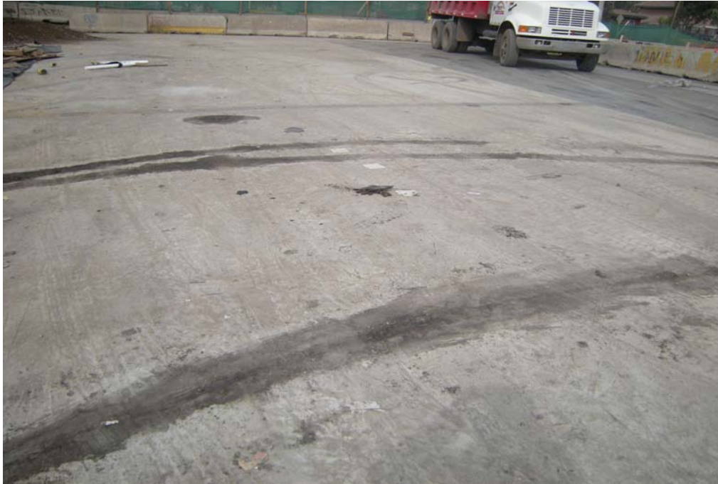
Fig. 6.1.3.14.9 Losa Calzada Oriente Fin Tramo 3. Zona con terminación superficial deficiente. Reparada.
