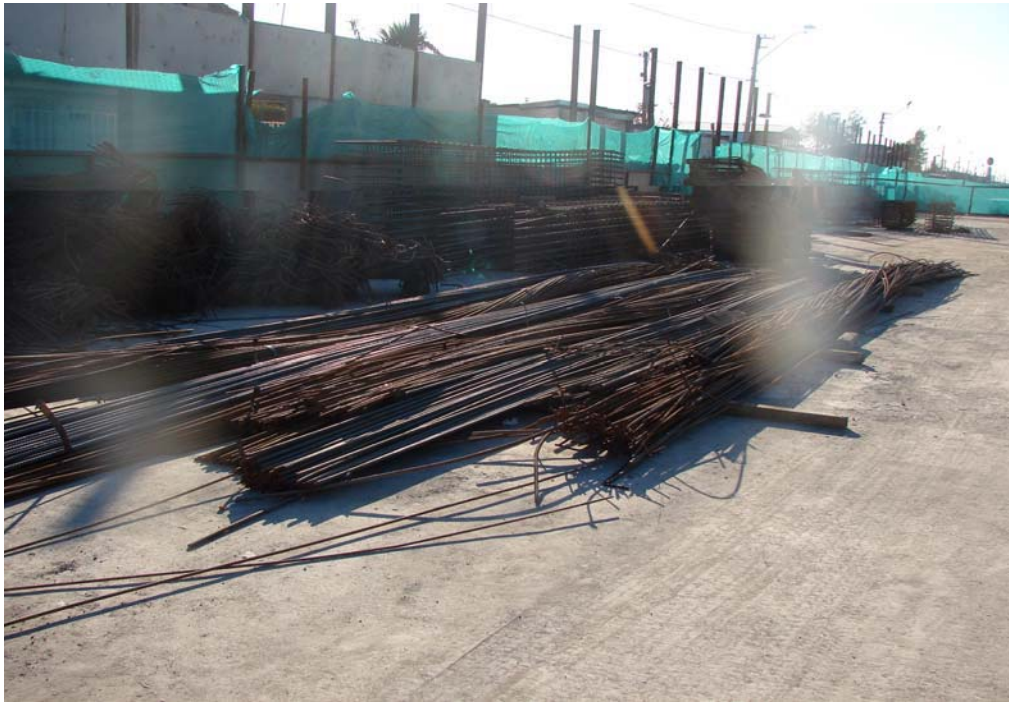
Fig. 6.1.3.6.1 Losa Zona Control 1. Se aprecia acopio de armaduras, impidiendo una buena inspección, sin embargo en zonas despejadas no se aprecian fisuras.
