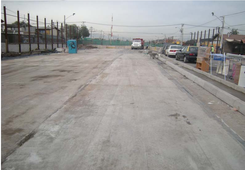
Fig. 6.1.3.14.5 Losa Calzada Oriente Fin Tramo 3. Sin pavimento con losa a la vista. Sin fisuras. Se aprecian losas con malas terminaciones superficiales.
