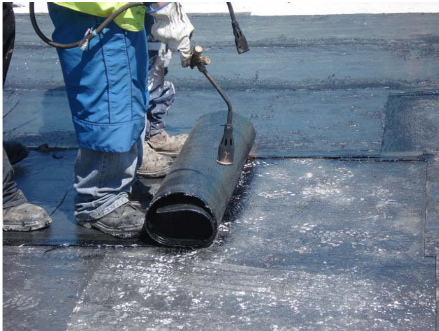
Fig. 2.3.22 Colocación de Membrana de Impermeabilización en Cubierta de Losa. La implementación de esta membrana ha sido para evitar al máximo la posibilidad que las fisuras en la losa puedan afectar el servicio de la estructura.
