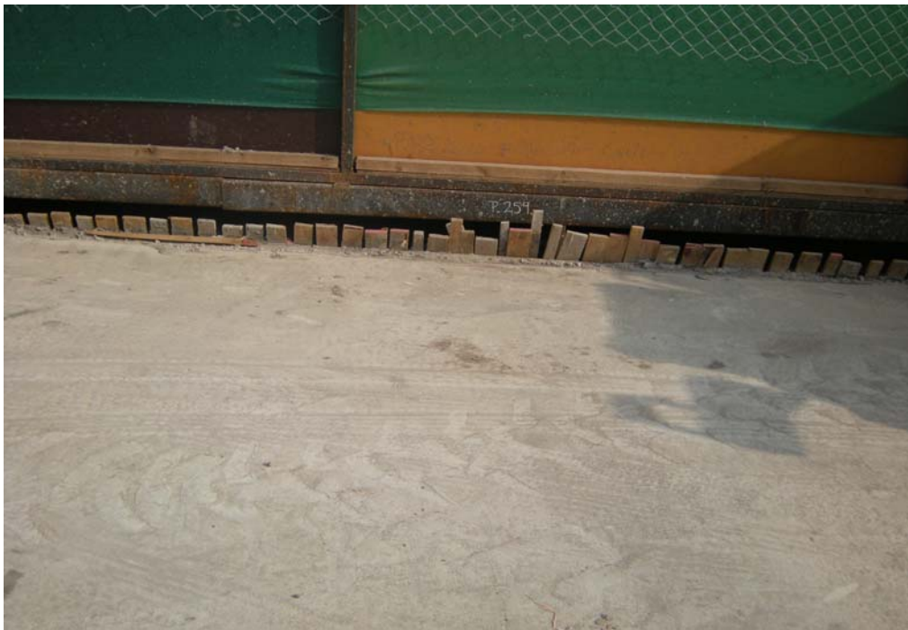
Fig. 6.1.3.8.2 Losa Zona Control 1. Sector pilotes extremos lado poniente. Se aprecia que la zona bajo la pasarela se encuentra aún sin hormigonar. Losa sin fisuras.
