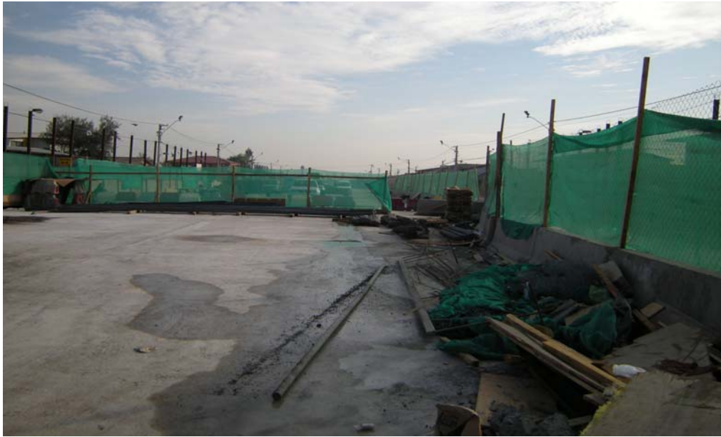
Fig. 6.1.3.1.1 Losa Poniente en Zona Pilotes. Losa aledaña a losa control, se puede apreciar que las losas ya hormigonadas se utilizan para almacenar diferentes objetos y materiales de obra.
