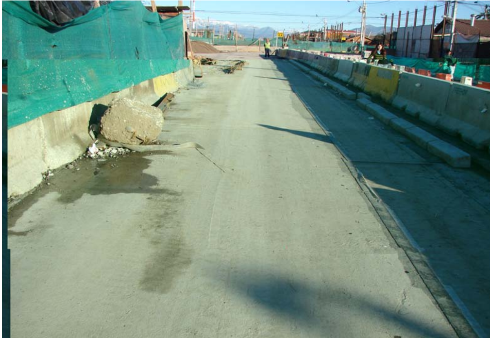
Fig. 6.1.3.12.5 Loseta de Continuidad en Zona Control 1. Sin membrana ni pavimento. A la fecha no presenta fisuras. Se puede apreciar restos de basura y escombros.
