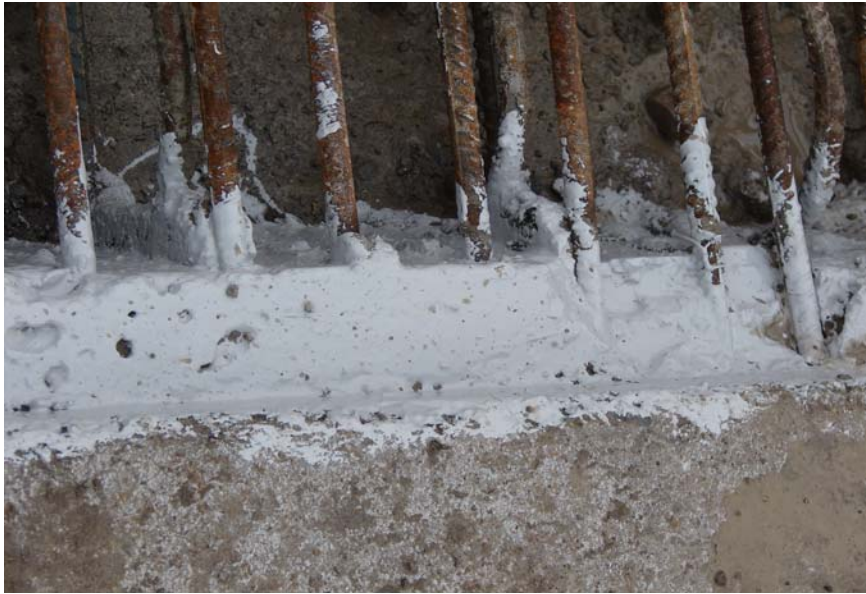
Fig. 2.3.12 Tratamiento de Junta de Construcción. Se ha utilizado puente de adherencia epóxido.
