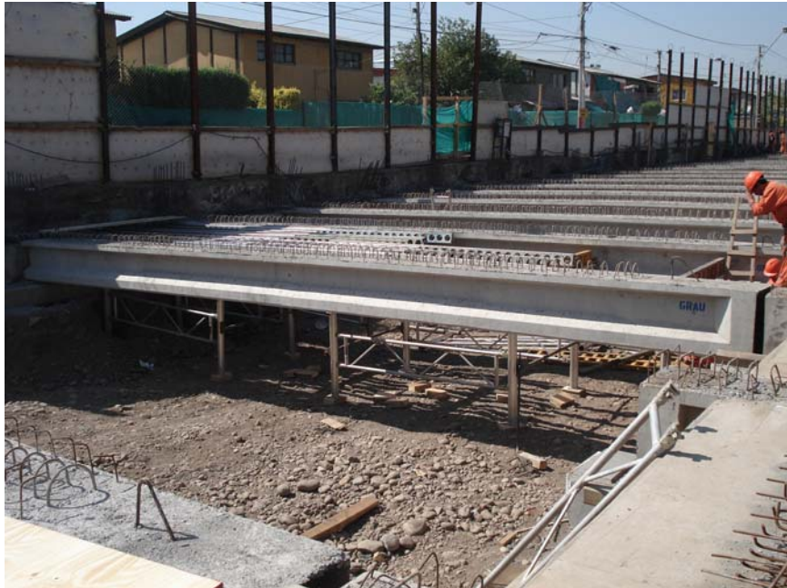
Fig. 2.3.1 Colocación Vigas Prefabricadas. Se aprecia que el alzaprimado esta apoyado contra terreno natural. Finalizado todo el proceso de hormigonado se procede a la excavación y retiro del material para dar paso a la construcción de la autopista por el eje inferior.
