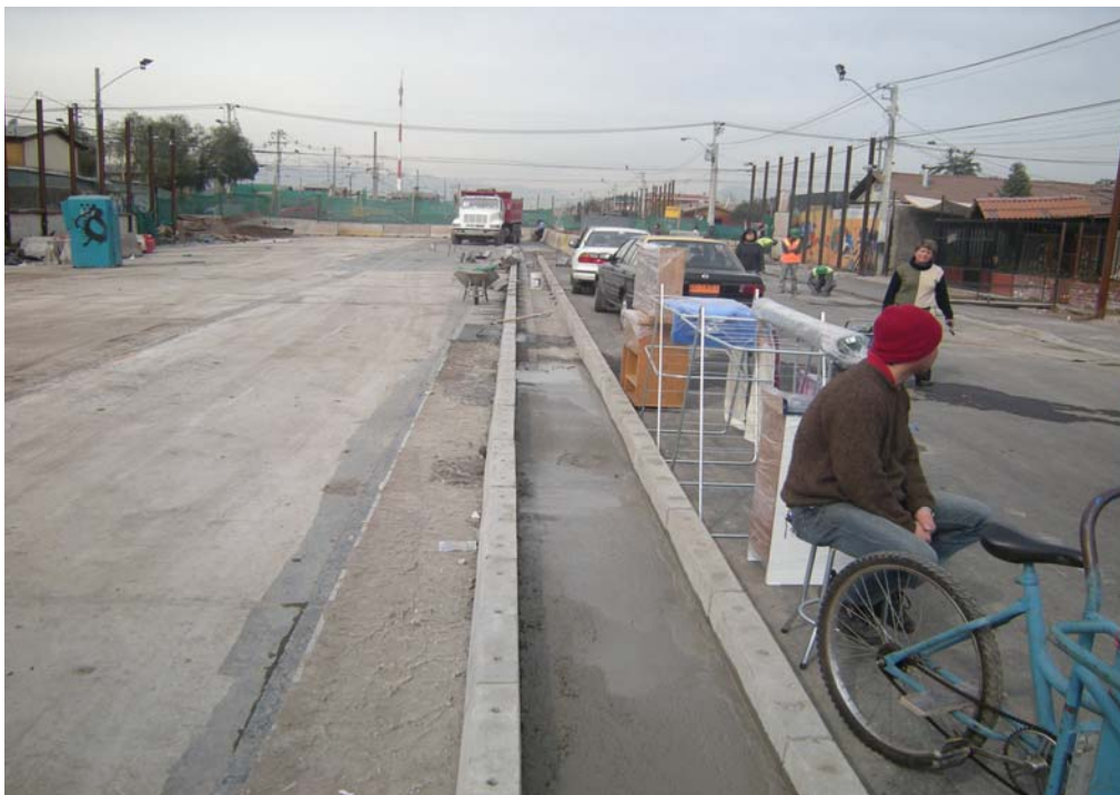
Fig. 6.1.3.14.4 Losa Calzada Oriente Fin Tramo 3. Sin pavimento con losa a la vista. Sin fisuras. Se aprecian algunas losas con malas terminaciones superficiales.
