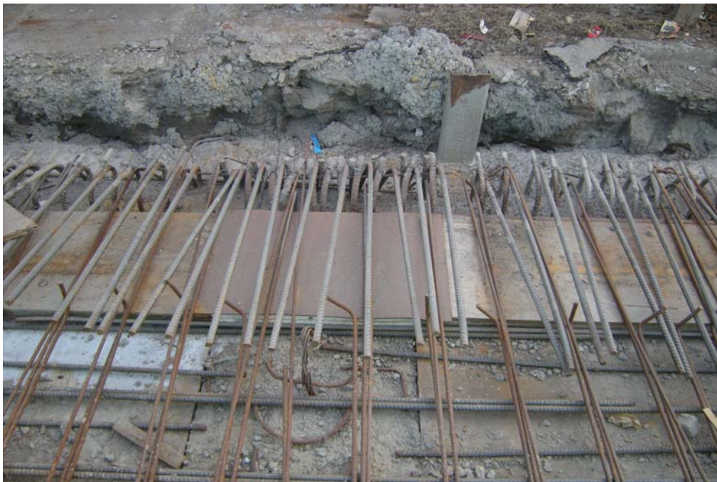
Fig. 6.1.3.11.2 Estado Losa Zona Control 1. Acercamiento armaduras de pilote y losa en zona de conexión Losa-Pilotes. Extremos lado poniente.
