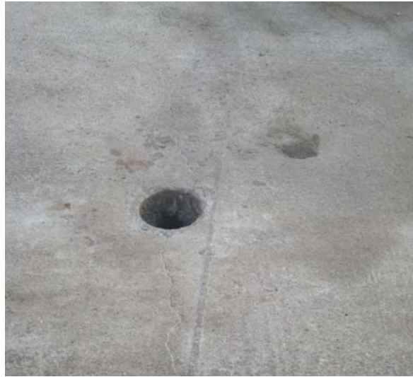
Fig. 7.1.1.1.1.3 Acercamiento Zona de Fisura y Muestreo Testigo N°2.
