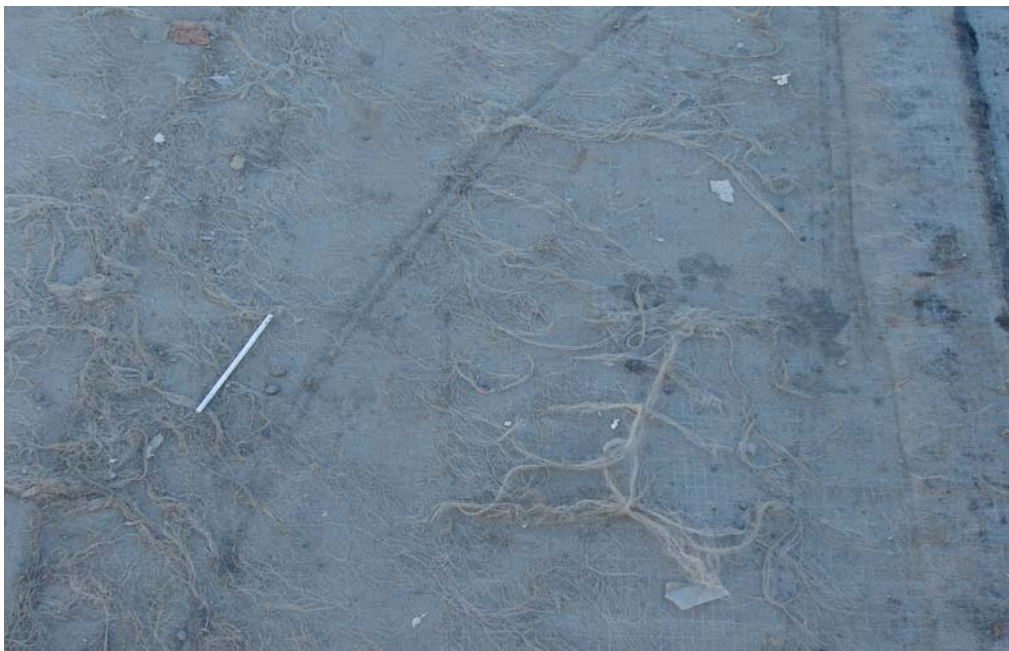
Fig. 6.1.3.12.6 Zona de Control 1. Membrana en zona de loseta de continuidad junto al pavimento colocado. Se puede ver cierto desprendimiento de las fibras debido al tráfico sobre la membrana.
