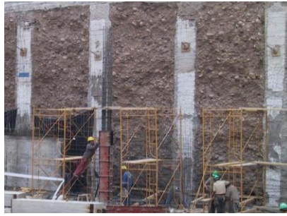
Figura 5.1: Imagen de pilas ancladas edificio Vista Riesco II, Santiago; Fuente: Pilotes Terratest Mayo 2010.
