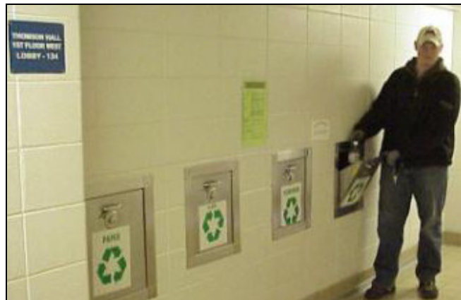
Figura 3.40 Ductos de reciclaje.
