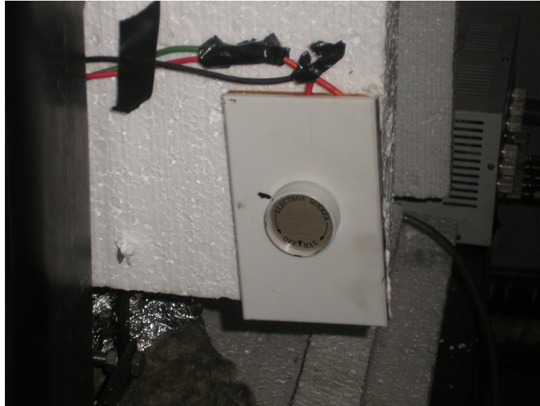
Figura 4.2: Dimmer añadido a la parte lateral de la Caja Térmica
