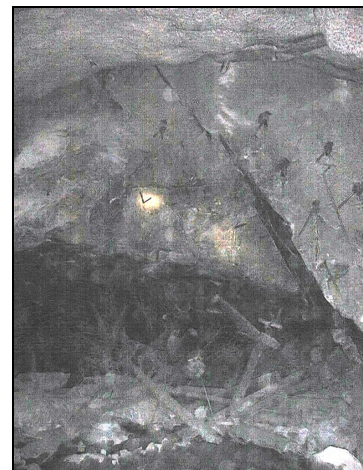
Fotografía 8: Ejemplo de uno de los bloques de gran tamaño que afecta al techo de la Calle CP-65.
