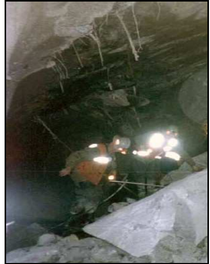
Fotografía 2: Desplome del bloque que afectaba el techo de la intersección C17/Z23, Nivel de Producción, Sector Esmeralda (vista desde el Oeste por Z13, tomada de Seguel, 2002).
