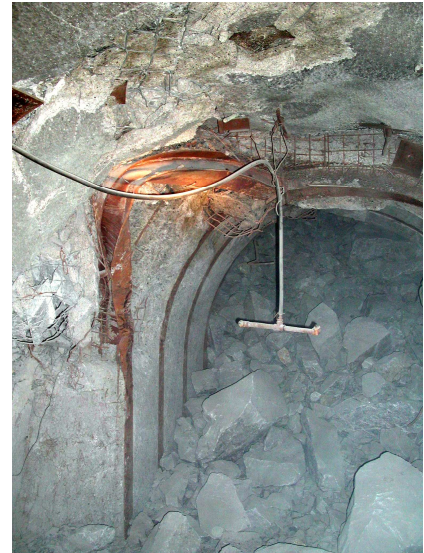
Fotografía 4. Deformación notoria del marco exterior del punto de extracción C23/Z12, Nivel de Producción, Sector Esmeralda.
