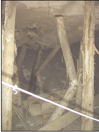
Fotografía 6: "Monos" en el sector de la Calle CP-57 afectado por descenso del techo.
