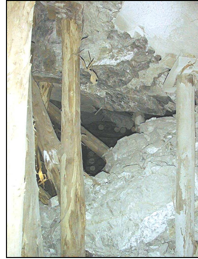
Fotografía 7: "Monos" en el sector de la Calle CP-61 afectado por descenso del techo.
