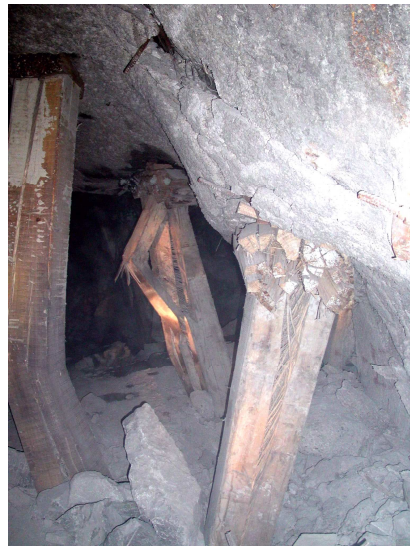
Fotografía 3. Daños importantes en la fortificación y descenso del techo, con "monos" bastante cargados en calle C23 con zanja Z13, Nivel de Producción, Sector Esmeralda.
