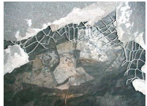
Fotografía 10: Daños en el techo de la intersección CP-61/BP-19.
