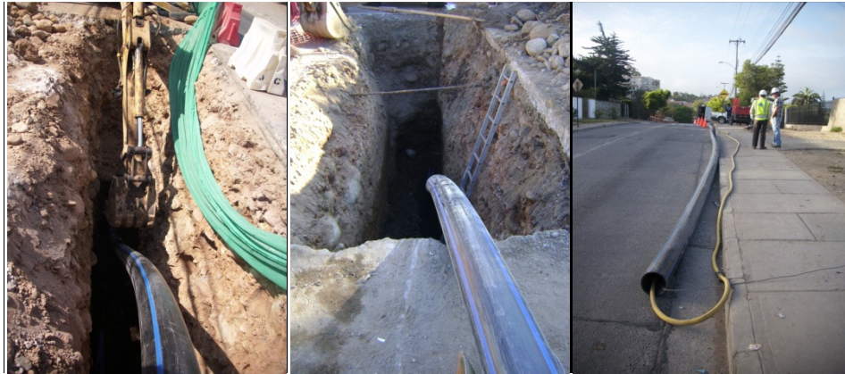
Figura 4-18: Insertado de la tubería con ayuda de retroexcavadora (izquierda), tubería en instalación (centro), tubería con línea hidráulica para martinete (derecha).
