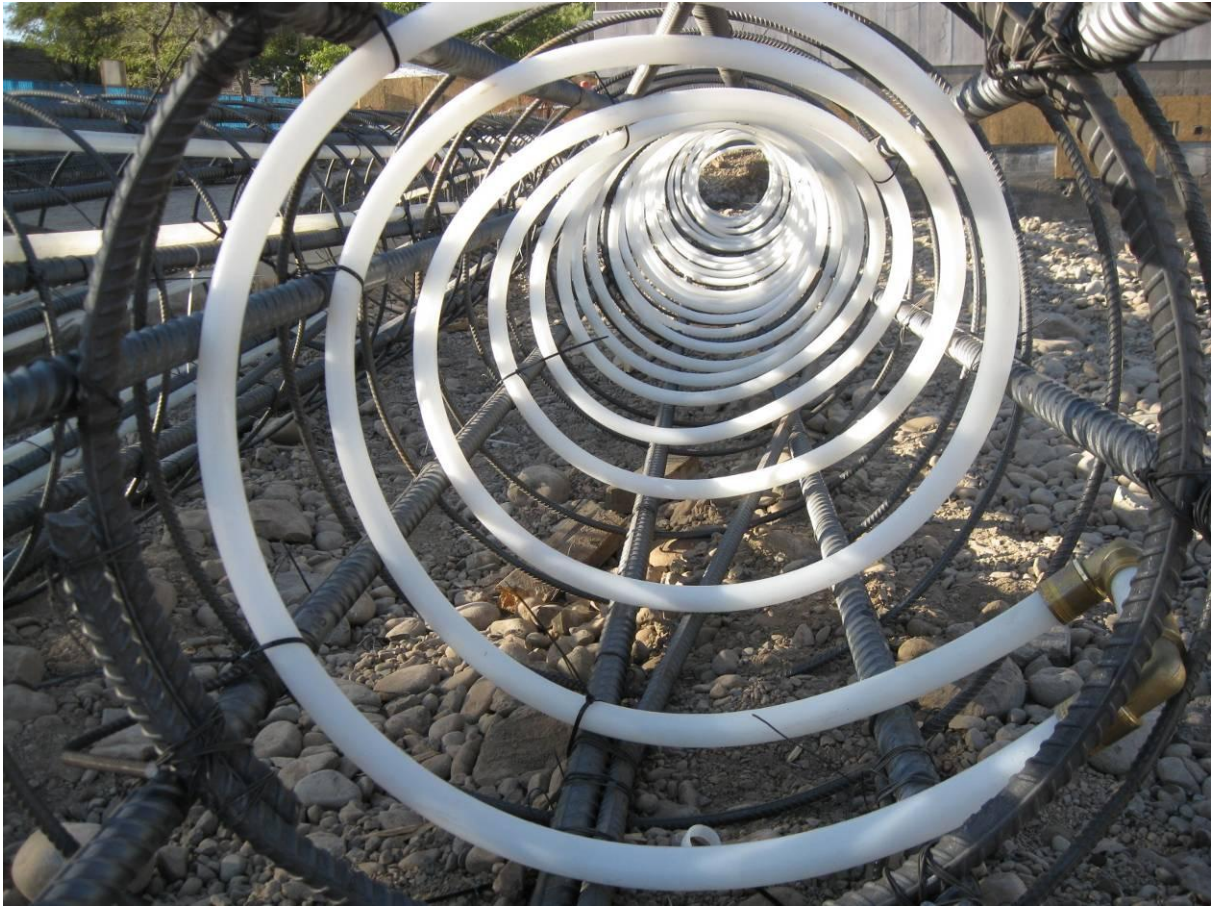
Figura 2.17 Fotografía de PE100 implementada con circuito helicoidal.
