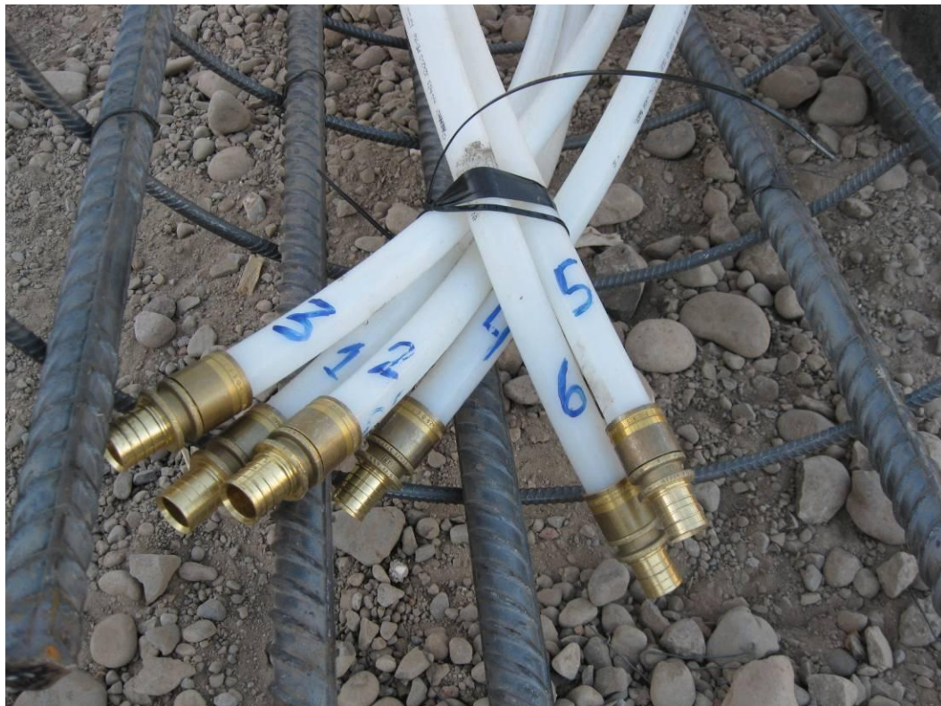
Figura 2.8 Numeración de las cañerías para la correcta conexión entre los cuerpos.
