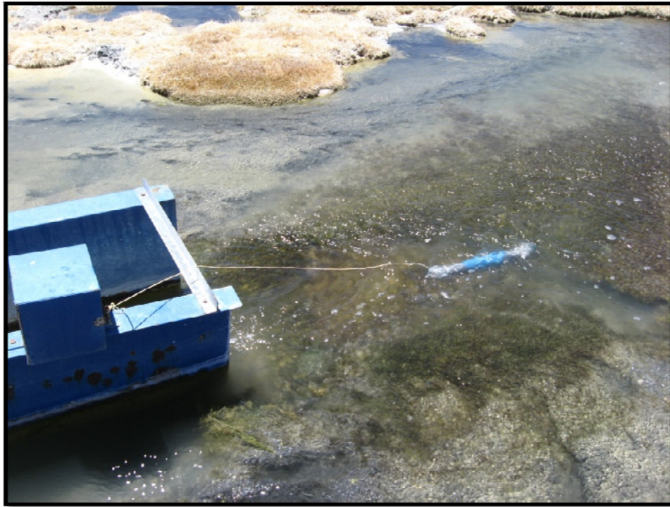
Figura N° 3.12: Fotografía de conductivímetro instalado en Tuyajto Norte.
