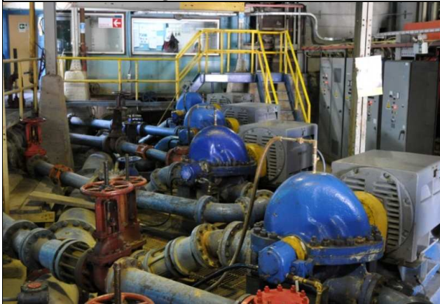
Figura C.3: Bombas de impulsión de agua de contacto mina hacia el sector de Sewell
