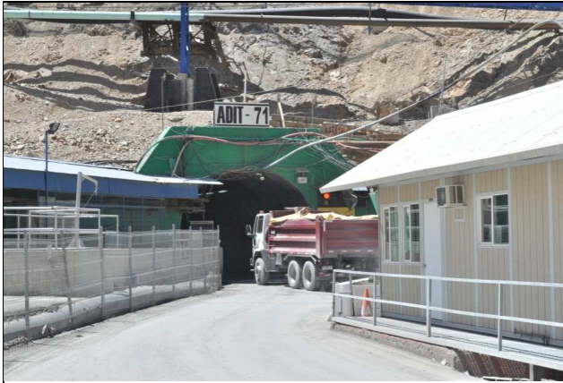
Figura C.1: Entrada al Adit 71. Principal captación del agua de contacto mina
