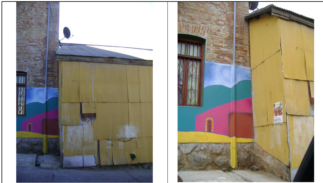
Ilustración 3.4.9. Fotografías eje D con eje 1 desde fachada exterior
