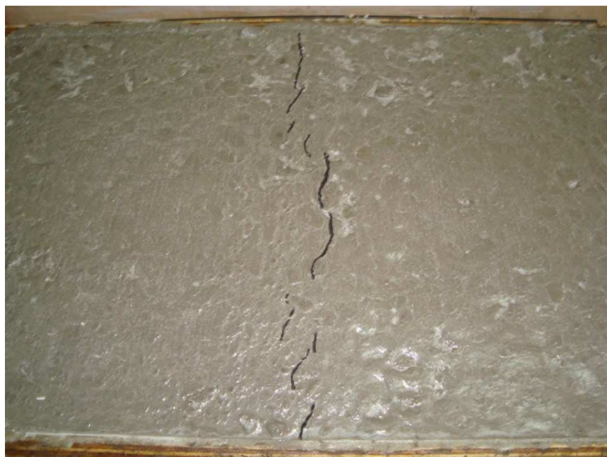
Figura N° 6.3. Fotografía correspondiente a la fisura entrecortada, distinta al patrón característico que se observo en los ensayos.
