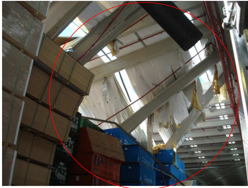
Figura 4.8: Caída vigas de costaneras
