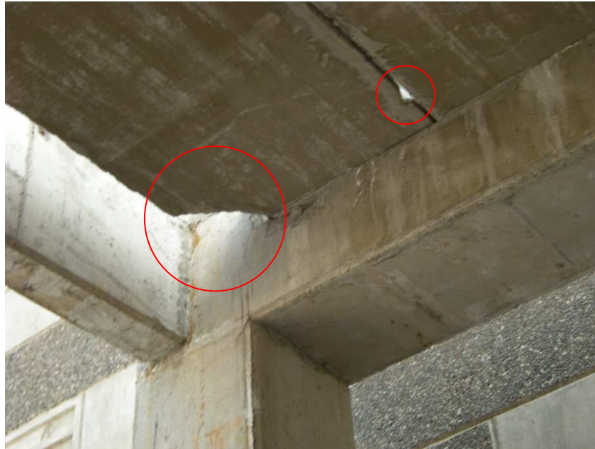
Figura 4.20: Pérdidas de sección en losetas prefabricadas
