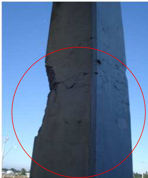
Figura 4.10: Pilar fisurado a 2 metros de la base
