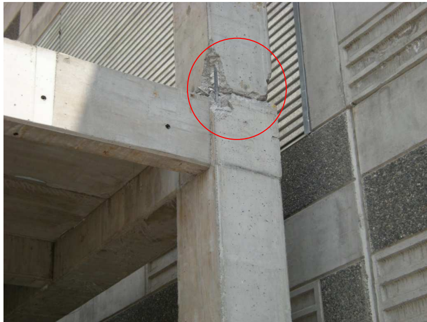
Figura 4.21: Desprendimiento de hormigón en nudo viga – pilar primer y segundo nivel.
