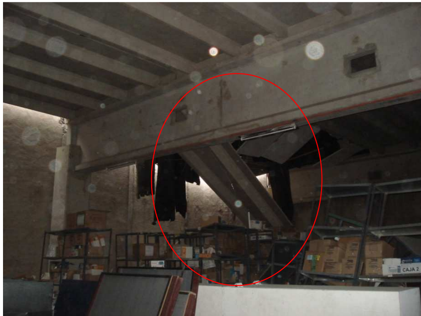
Figura 4.4: Caída de losa prefabricada de techo
