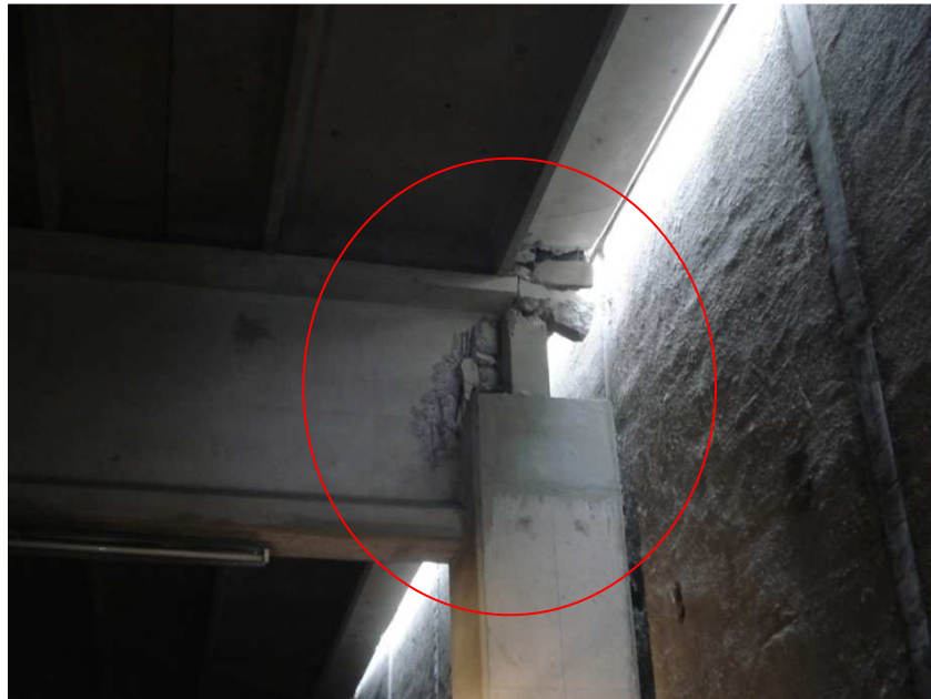
Figura 4.2: Daño en conexión seca pilar - viga principal
