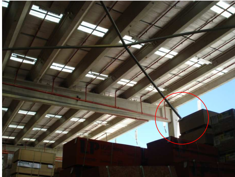
Figura 4.9: Pérdida de la conexión arriostramiento – viga
