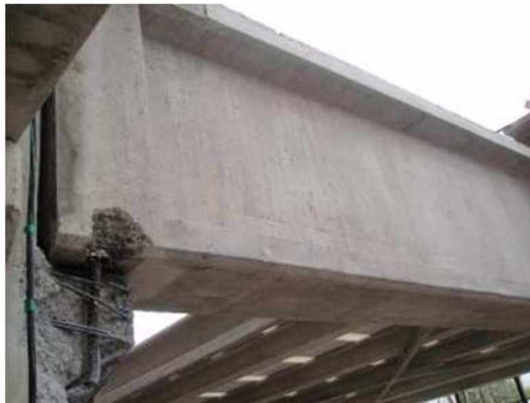
Figura 5.9: Daño en ménsula de conexión viga - pilar
