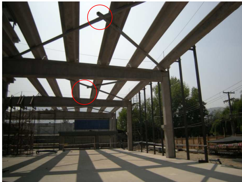
Figura 4.18: Falla de arriostramientos en base a perfiles de acero
