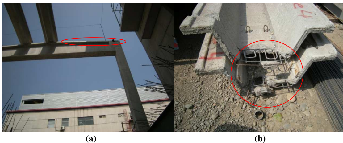
Figura 4.19: Falla de conexión costanera viga principal y caída del elemento
