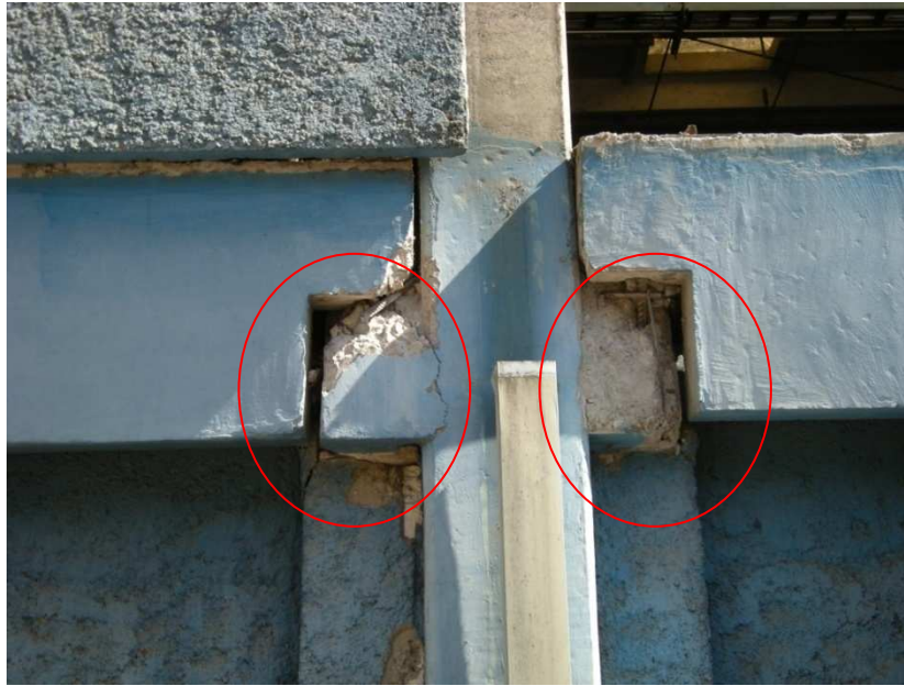
Figura 4.16: Desprendimiento de hormigón ménsulas de apoyo, pilar intermedio
