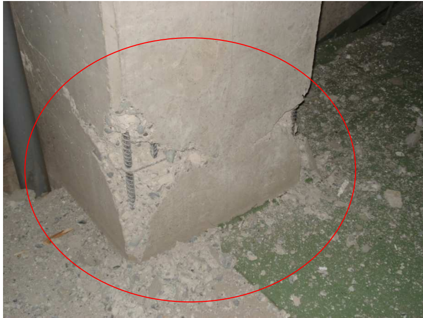
Figura 4.3: Daño en base de pilar
