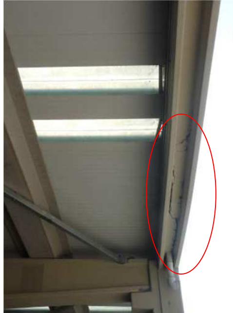
Figura 4.14: Viga secundaria fisurada
