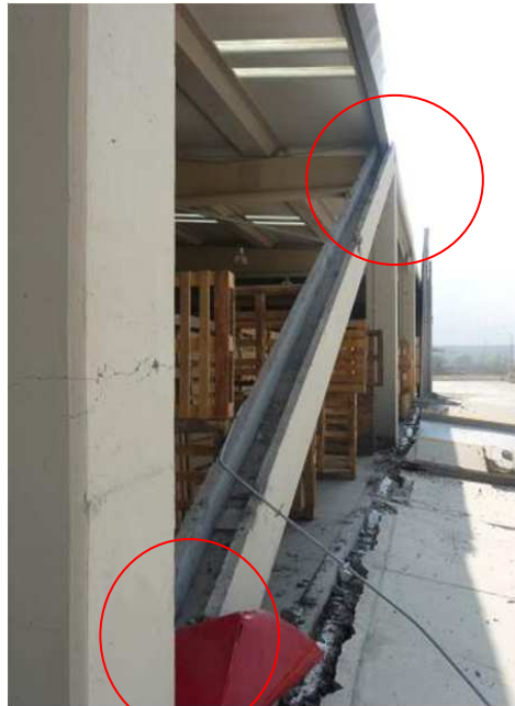
Figura 4.12: Colapso conexión pilar - viga secundaria
