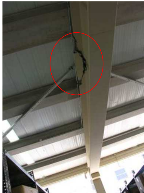
Figura 4.13: Arrancamiento de arriostramientos de viga principal
