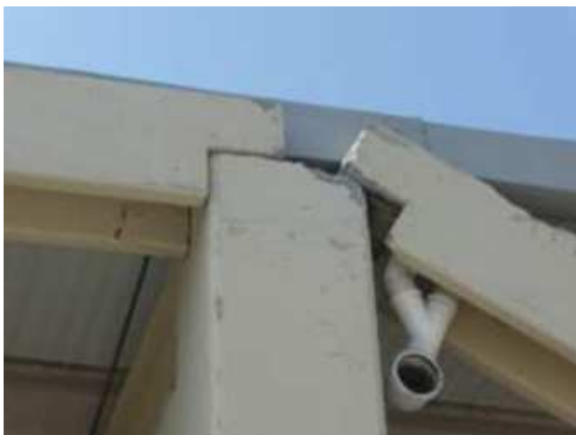
Figura 5.2: Caída de viga secundaria producto del desplazamiento de la estructura
