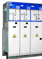
Figura 3.8: Celdas de Media Tensión (grupo de tres módulos)
