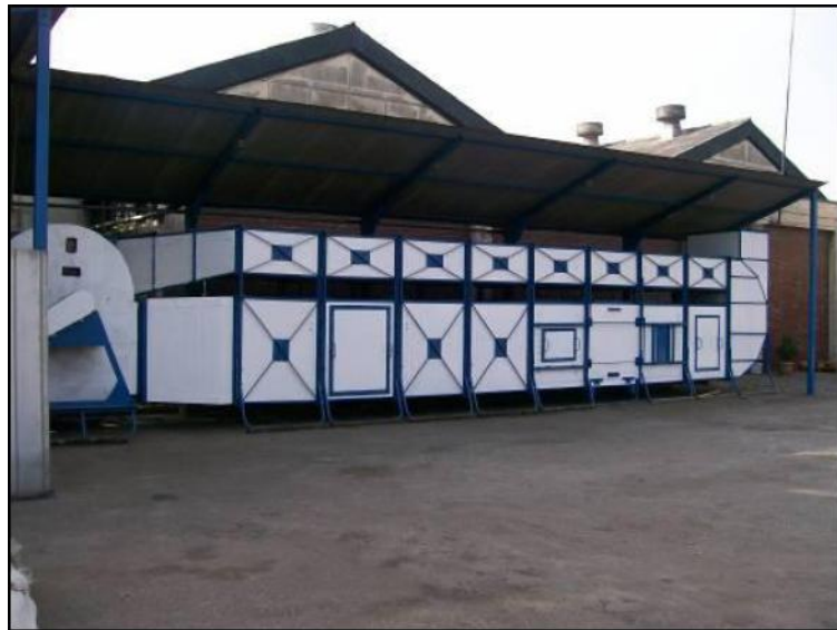
Figura 4.13: Vista General de la planta piloto
