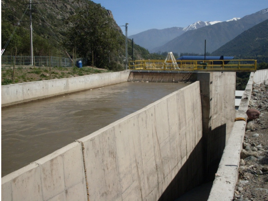
Figura 20. Cámara de Carga y Vertedero de Seguridad
