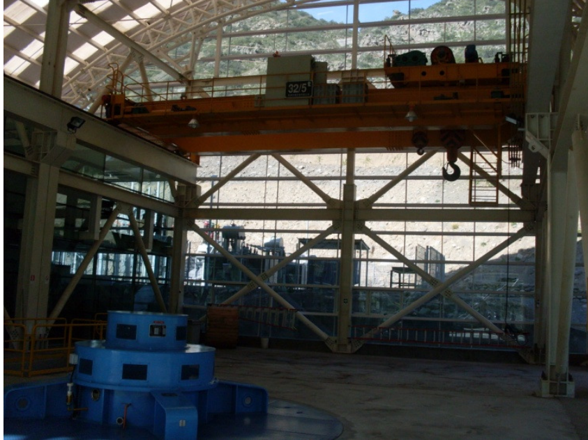
Figura 22. Vista interior casa de máquinas
