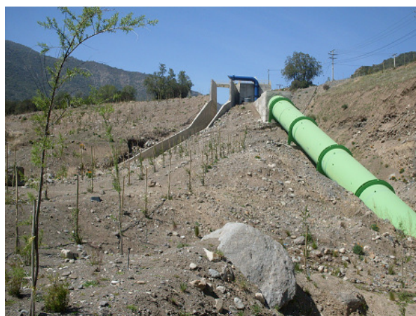
Figura 13. Tubería en presión Central Guayacán
