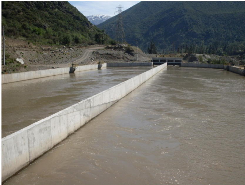
Figura 19. Desarenadores y compuertas de descarga de rípios
