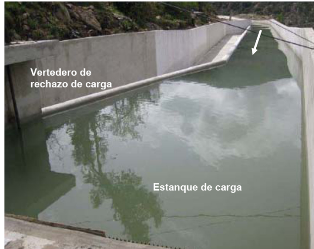
Figura 12. Vertedero y estanque de carga tipo Fuente: DIA Mini Central Hidroeléctrica Cayucupil.
