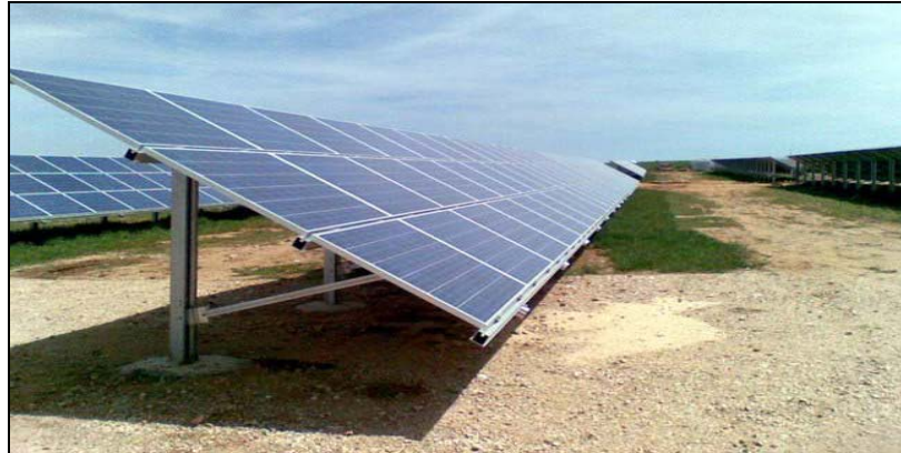
Figura 8: Instalación solar fija, inclinada en la latitud correspondiente (Almería).
