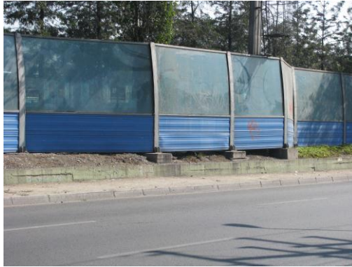
Figura n° 31: Orificio en sistema de barreras acústicas en Autopista Central.
