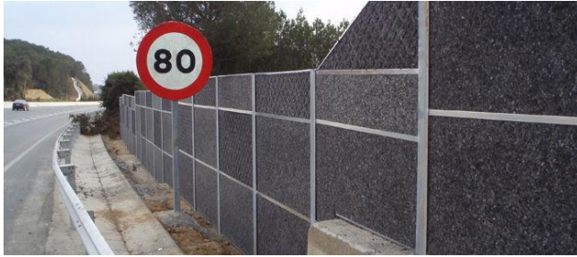
Figura nº 17: Barrera Acústica fabricada de aglomerado de tapiz de vehículo.
