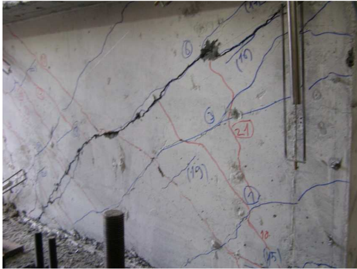
Figura 4.4 Grietas principales en el estado último de carga en muro SW-T1-S2-9 (Terzioğlu, 2011).
