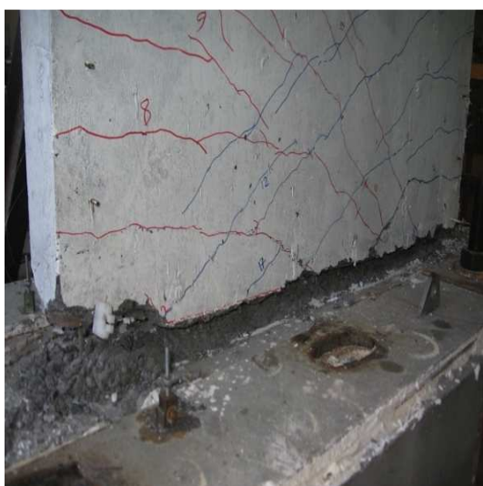
Figura 4.8 Falla por deslizamiento en muro SW-T3-S1-5 (Terzioğlu, 2011).
