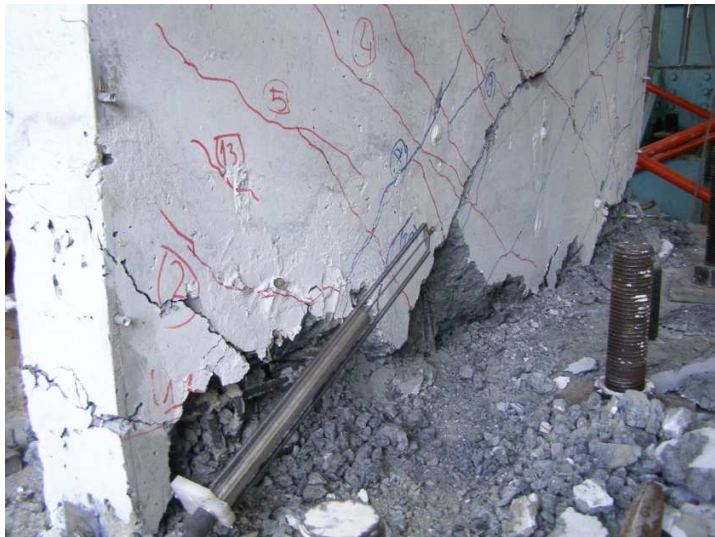
Figura 4.5 Daño severo en muro SW-T1-S2-9 (Terzioğlu, 2011).
