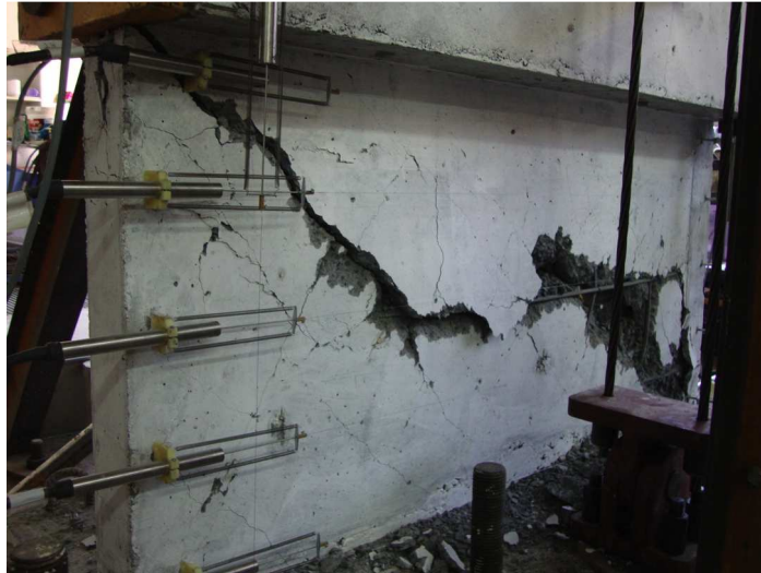
Figura 4.7 Daño severo en muro SW-T1-N10-S1-11 (Terzioğlu, 2011).
