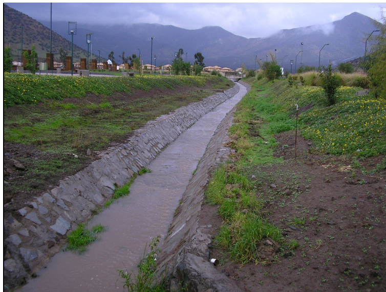
FIGURA 6.3 CANAL REVESTIDO EN ENROCADO, CONTINUACIÓN QUEBRADA LA VIRGEN, VALLE DE CHICUREO.
